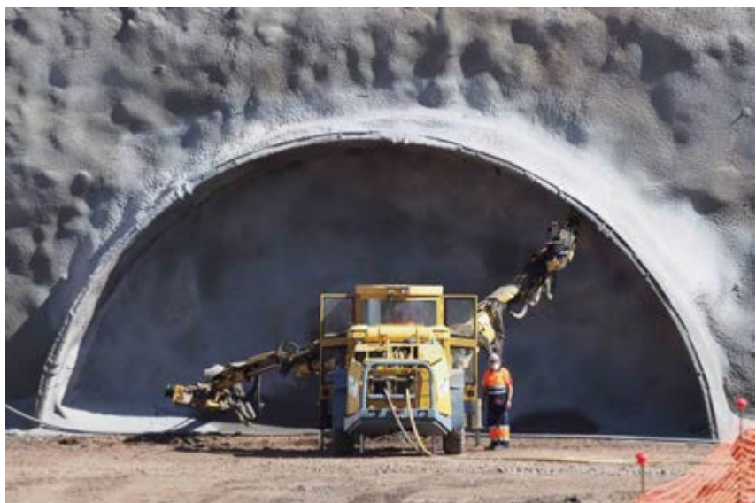
De arriba abajo, secuencia de la ejecución del emboquille de una de las bocas del túnel.
