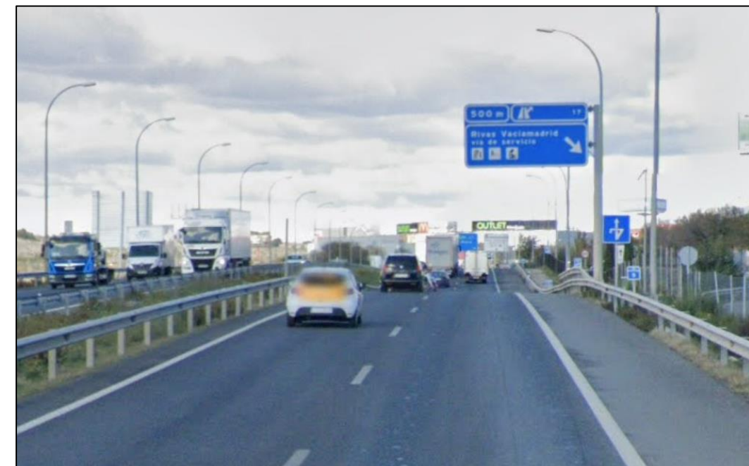
Tramo de acuerdos verticales existentes en calzada izquierda actual sin visibilidad de parada y con parámetros inferiores a los mínimos.
