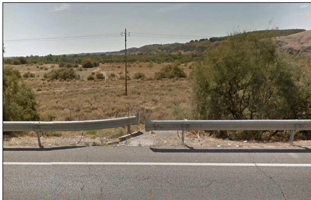
Paso para acceso a poste SOS en barrera metálica.
