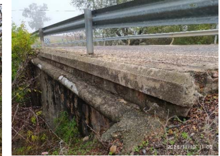
Puente aguas abajo, con tubería fuera de uso
