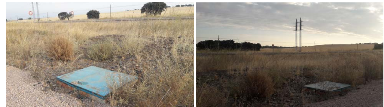
Arquetas de registro de la tubería de abastecimiento a La Albuera
