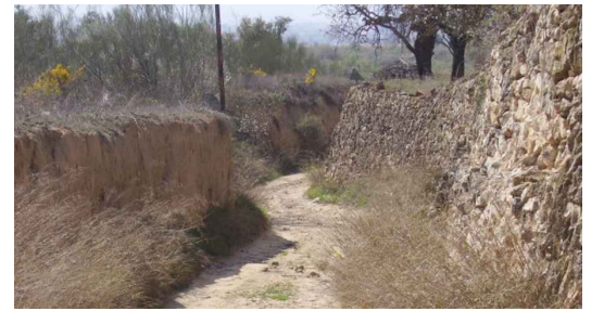
4_MURO DE MAMPOSTERÍA EN CAMINO DE ACCESO A PASO A NIVEL
