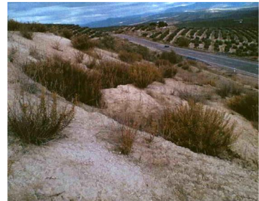
Foto 3. Deslizamiento rotacional en un talud excavado en materiales Miocenos.
