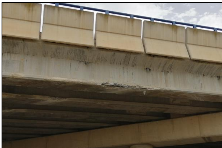
Imagen 21. Viga con daños en el ala, pérdidas de volumen de hormigón.
