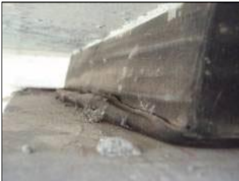
Imagen 34. Degradación del aparato de apoyo de neopreno.
