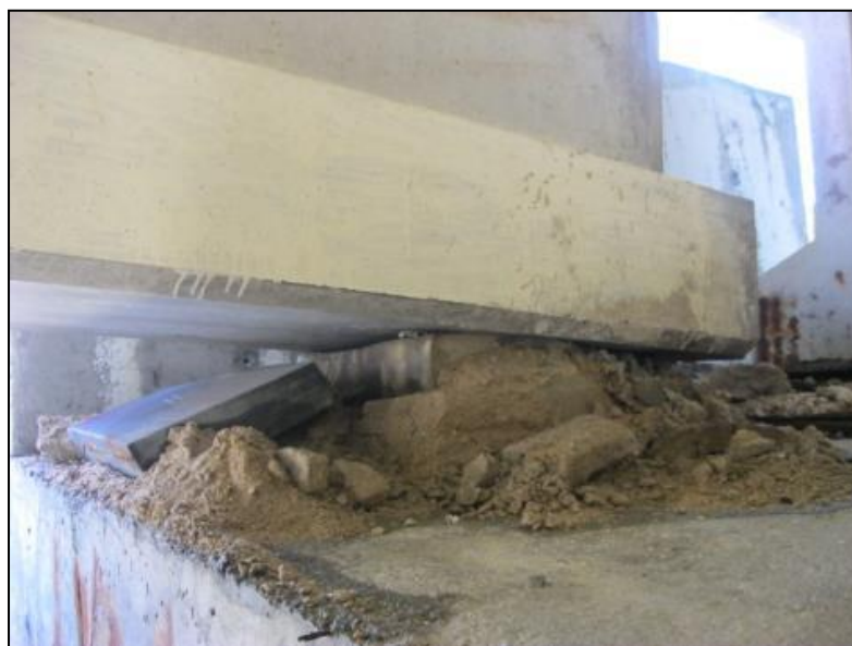
Imagen 33. Apoyo de neopreno desplazado y rotura de cama de nivelación.
