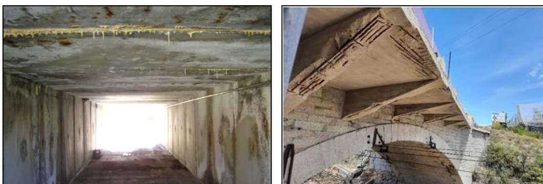
Imagen 4. Humedades y degradación del hormigón en la zona inferior del tablero.
