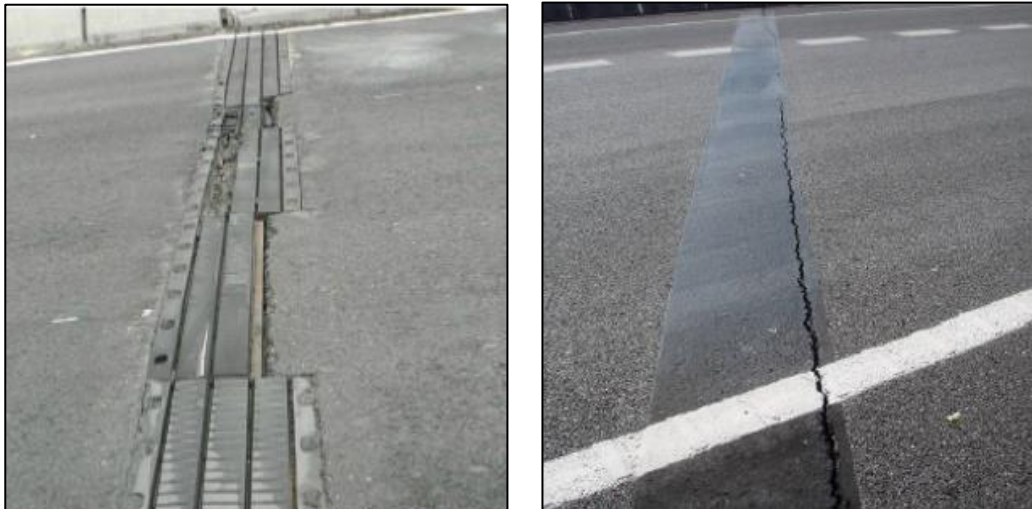
Imagen 23. Rotura de elementos y fisura en juntas de plataforma.
