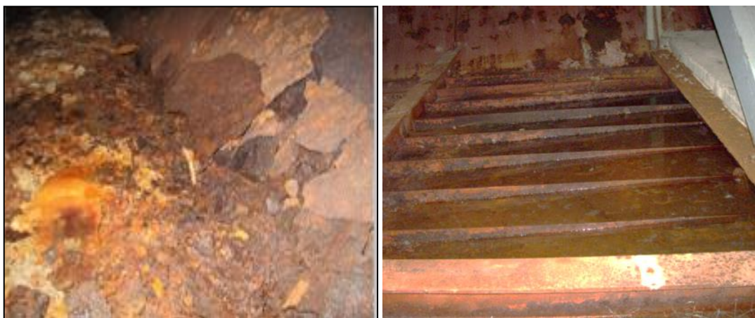
Imagen 8. Humedades en el interior de cajones metálicos.
