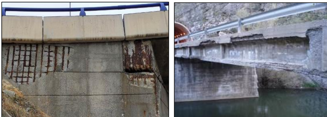
Imagen 1. Degradación del hormigón en los laterales.
