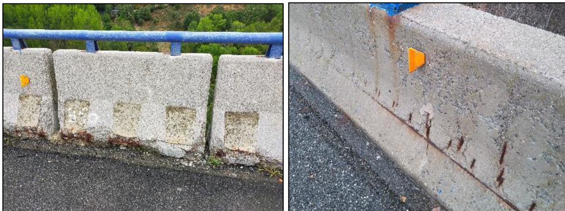
Imagen 25. Degradación del hormigón en pretilos mixtos.
