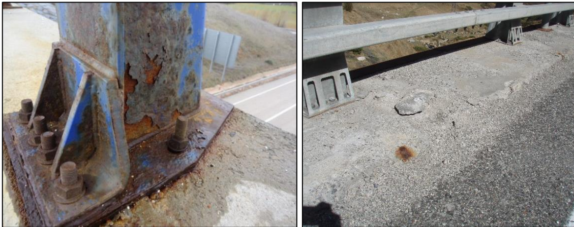
Imagen 29. Oxidación y meteorización en zócalo de anclaje de pretil.
