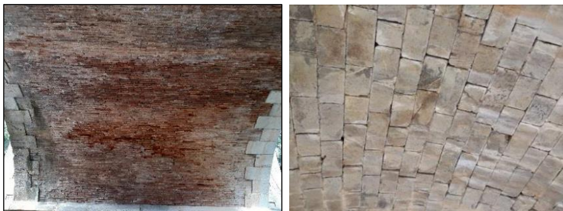
Imagen 10. Humedades en bóvedas de sillería y ladrillo.
