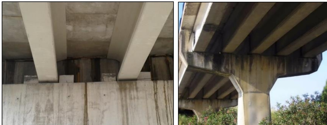
Imagen 12. Humedades en paramentos de estribo y pila.
