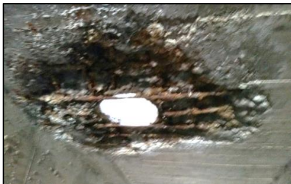
Imagen 14. Humedades en zona interior de marcos
