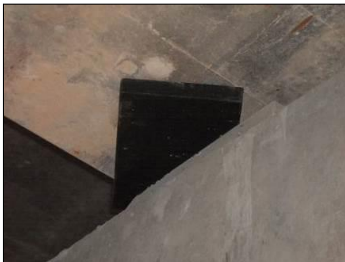
Imagen 32. Apoyo de neopreno desplazado de su posición original.
