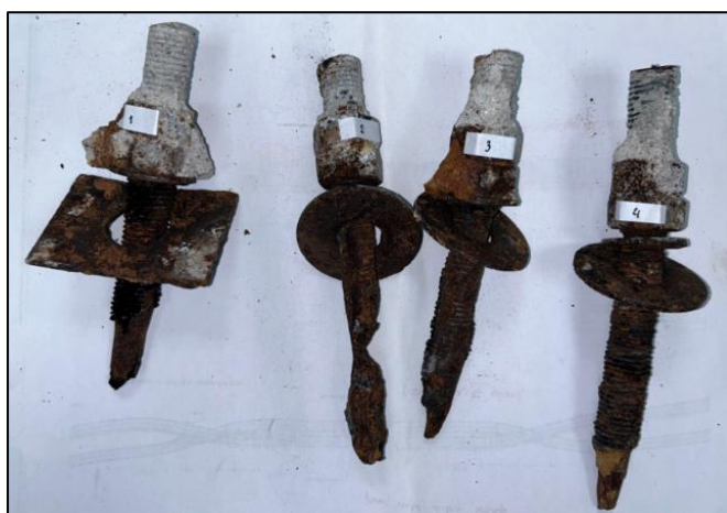
Imagen 24. Pernos de anclaje oxidados.
