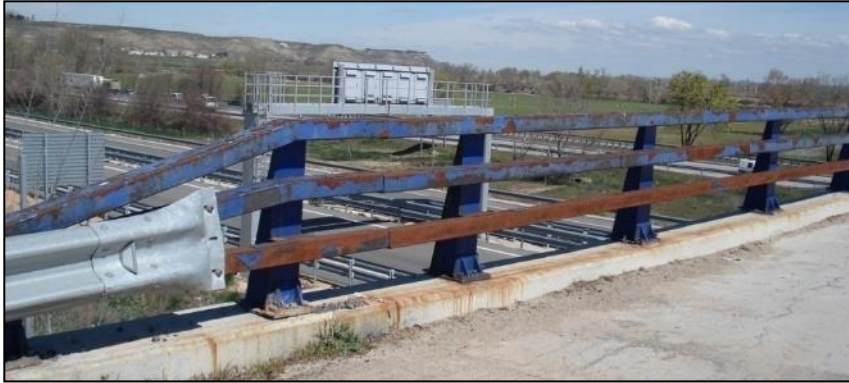
Imagen 28. Oxidación generalizada en pretil metálico.
