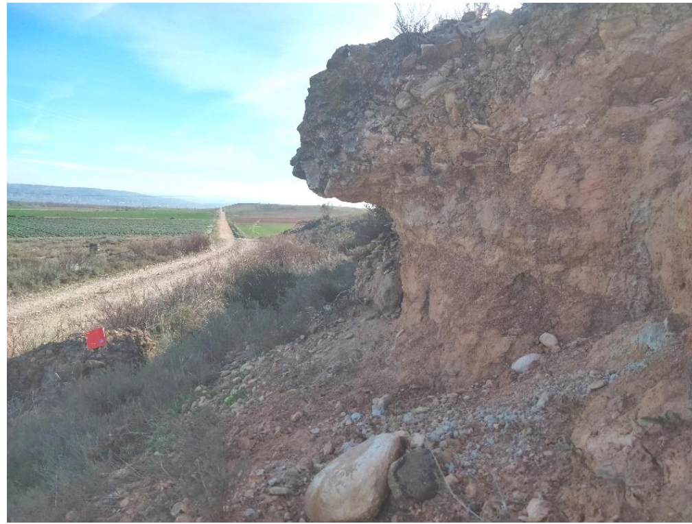
Figura 4.- Erosión diferencial entre margas y conglomerados en el P.K. 312+000
