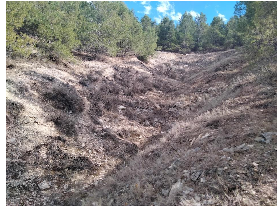
Figura 8.- Pequeño deslizamiento en calizas blanquecinas sobre arcillas calcáreas y limos pardo rojizos sobre el P.K: 222+000,
