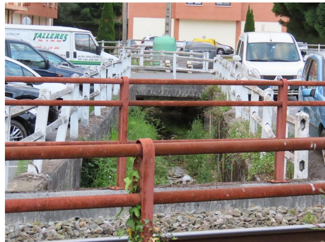
Estado del arroyo San Cristóbal en las cercanías de su desembocadura en el río Cadagua. Población de Zalla. Fuente: elaboración propia
