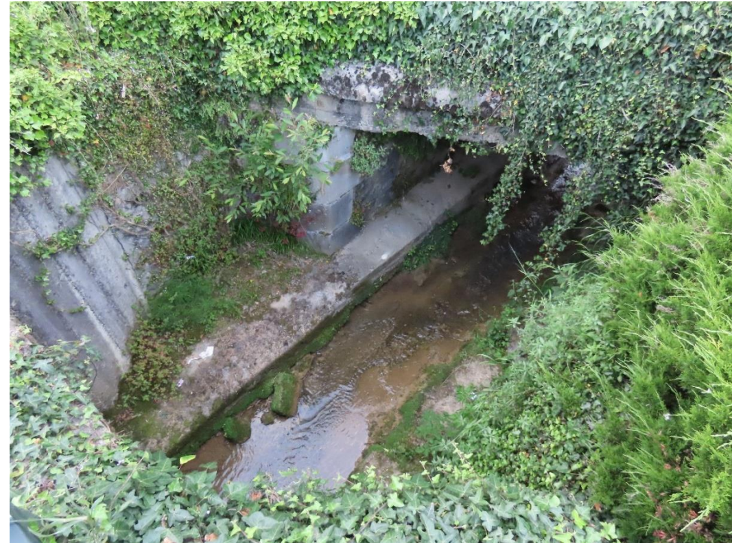
Arroyo San Cristóbal próximo a su desembocadura en el Cadagua. Canalización completa del cauce en el casco urbano de Zalla. Fuente: elaboración propia
