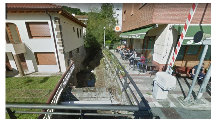
Estructura en la Calle Maestra Consuelo sobre el cauce del Maruri. Fuente: Google Maps
