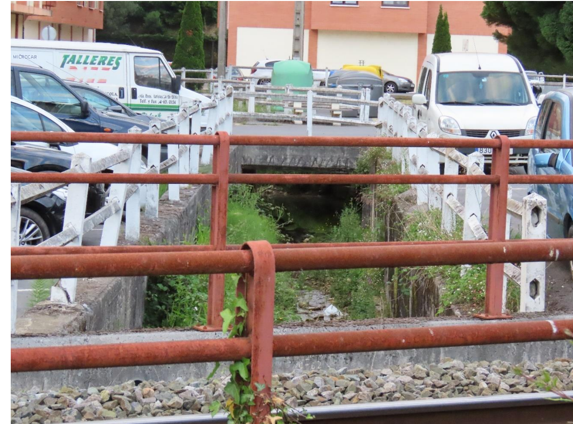
Estado del arroyo San Cristóbal en las cercanías de su desembocadura en el río Cadagua. Población de Zalla. Fuente: elaboración propia
