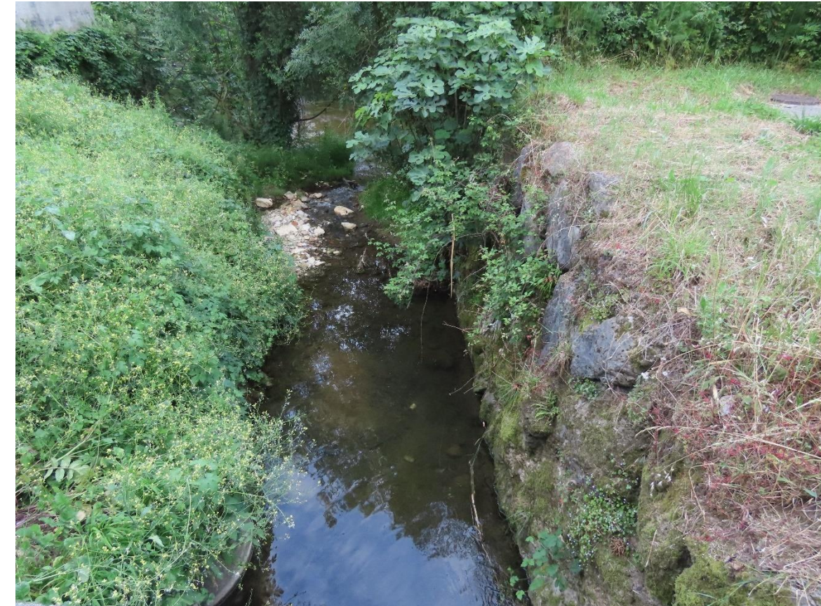
Vista del arroyo Maruri próximo a la desembocadura en el Cadagua. Riberas comprimidas y alteradas, con escolleras de protección. Población de Zalla. Fuente: elaboración propia
