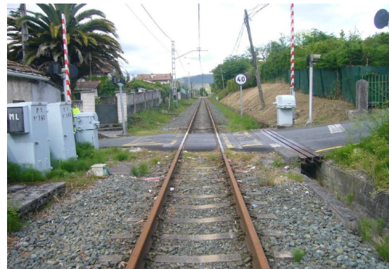
Imagen desde el eje de la vía en sentido decreciente de PK
