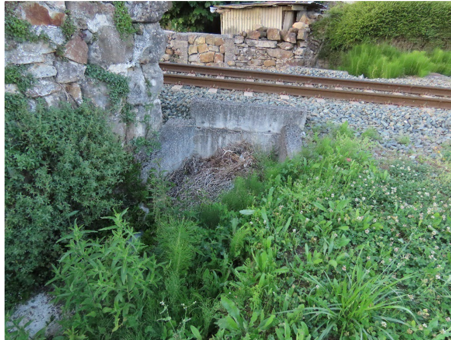
ODT existente en el PK 0+100 vía 790, salida
