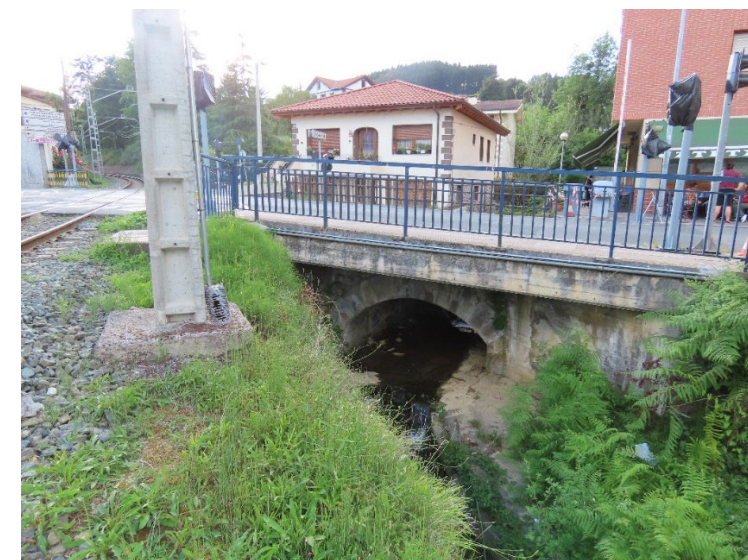
Puente sobre el arroyo Maruri en Calle Maestra Consuelo, que será objeto de ampliación
