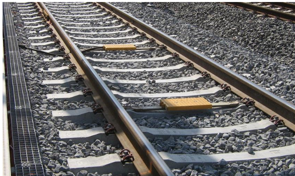
Figura 8. Ejemplo de implantación de eurobalizas en la vía del sistema ERTMS.
