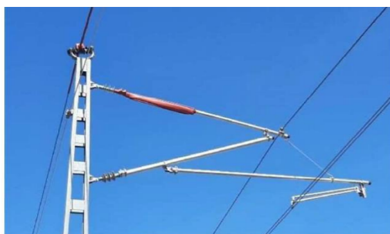
Protección antielectrocución en ménsulas. Fuente: ADIF.
