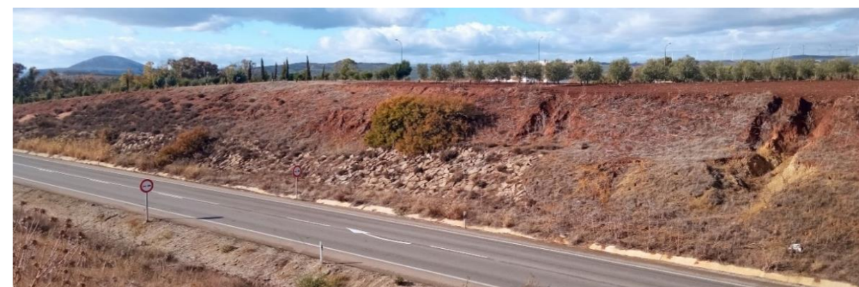
Cárcavas y deslizamientos en materiales de UG 4.
