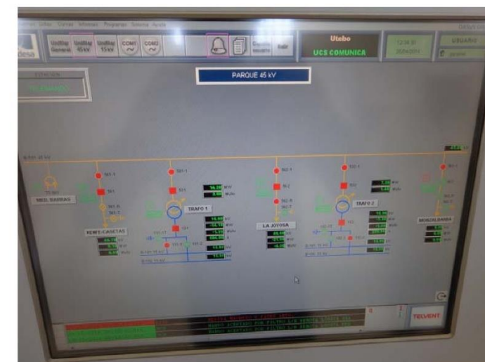
Figura 6. Medidas de potencia en remota de la subestación.
