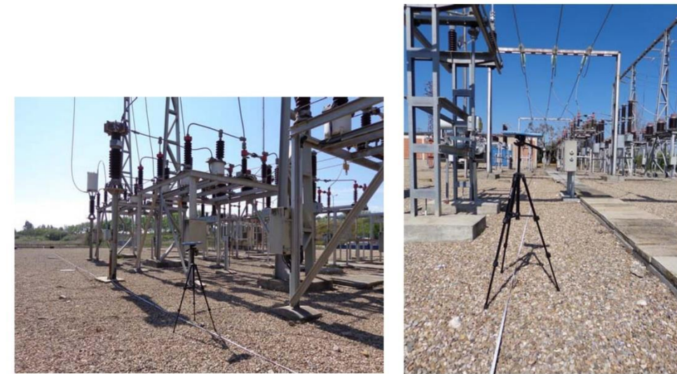
Figura 5. Equipo de medida en subestación Utebo, línea 1 P15 y línea 2 P1.
