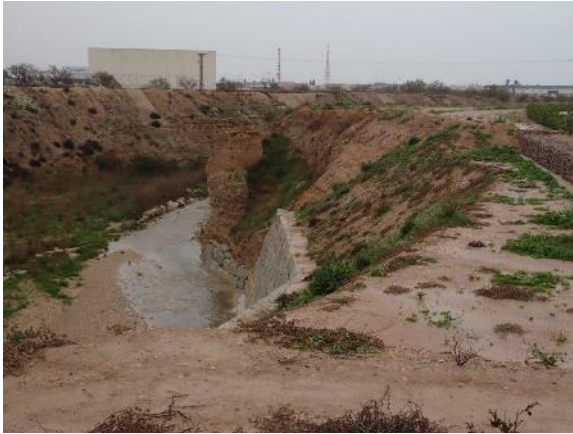
Figura 37: Vista general del arroyo con los niveles arcillosos que afloran en el Pk 0+200 de la Variante Este de la Alternativa 1.
