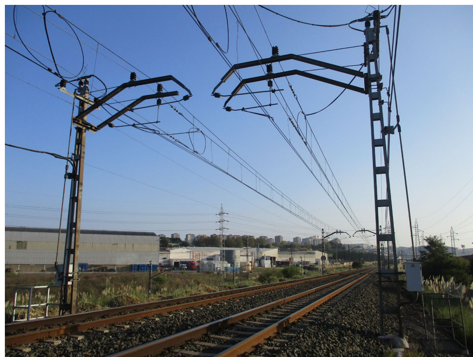
Figura 1. Seccionamiento en el inicio de la zona de actuaciones. Línea Santander – Bilbao.
