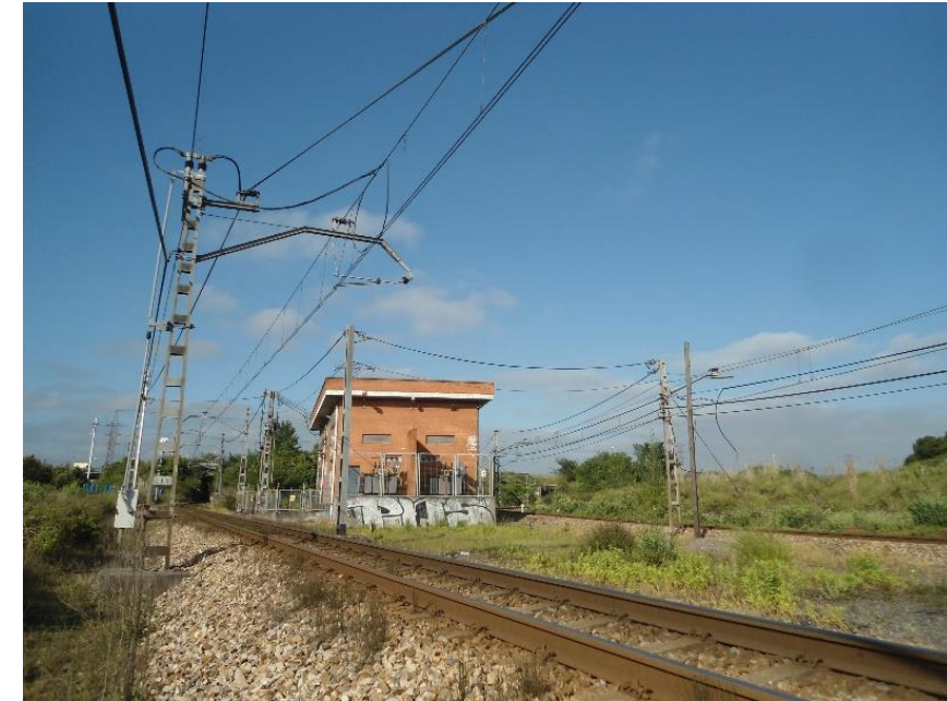
Subestación de tracción de 1,5 kV de Tremañes. Red Ancho Métrico.
