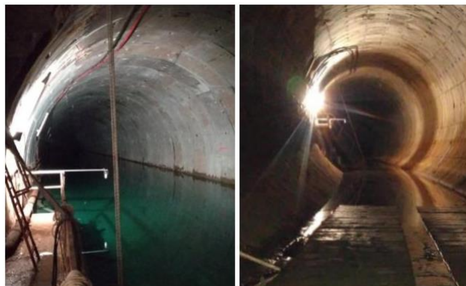
A la izquierda, túnel parcialmente inundado. A la derecha, situación actual del túnel tras la culminación del vaciado,
