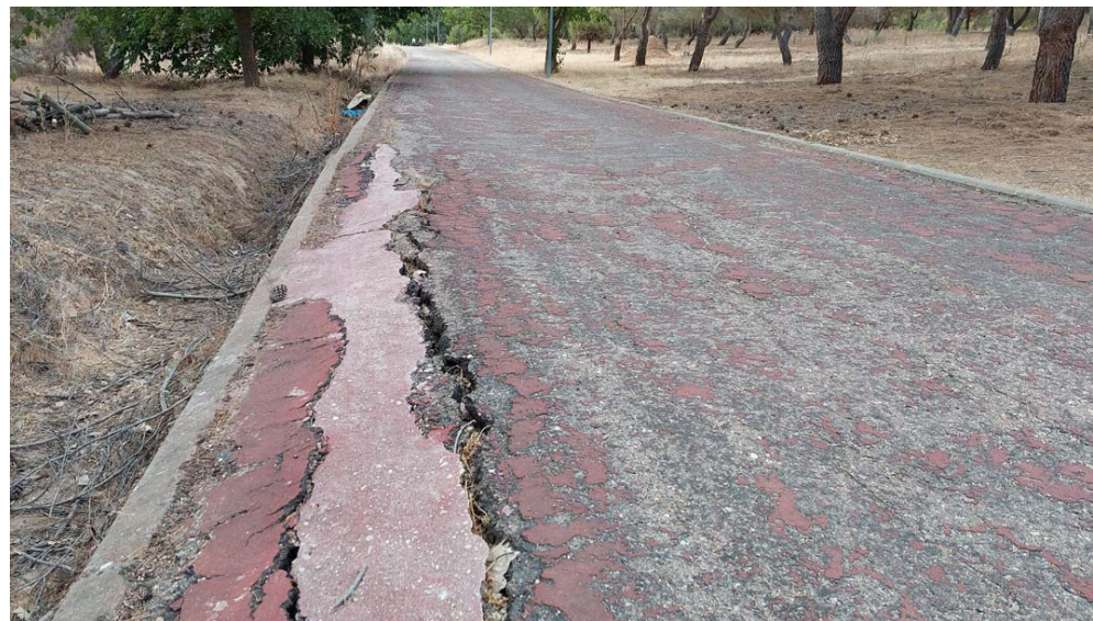
Fotografía 8.2 Ejemplo de pavimento en mal estado
