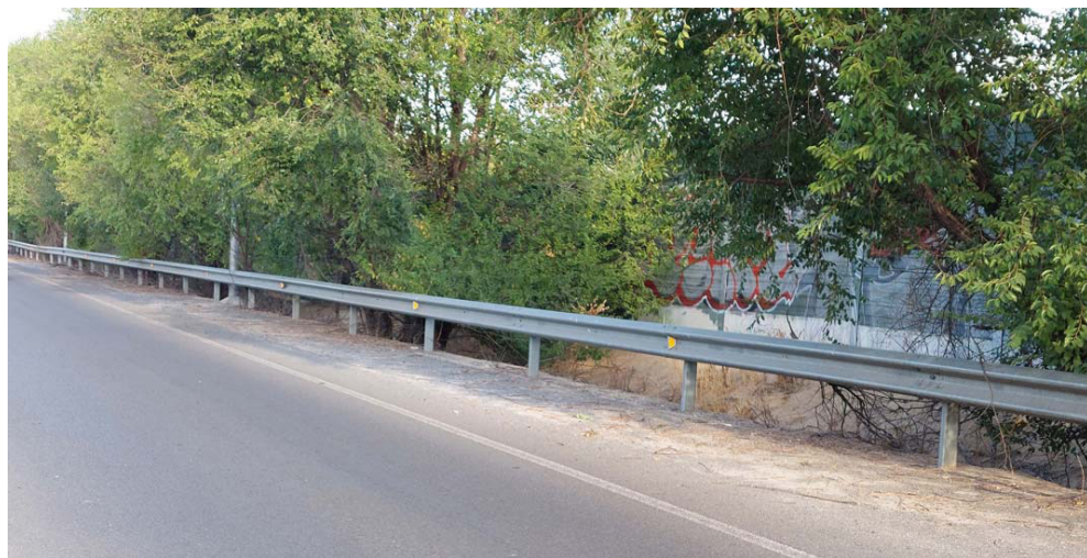
Fotografía 8.1 Ejemplo de arcén sin la adecuada limpieza
