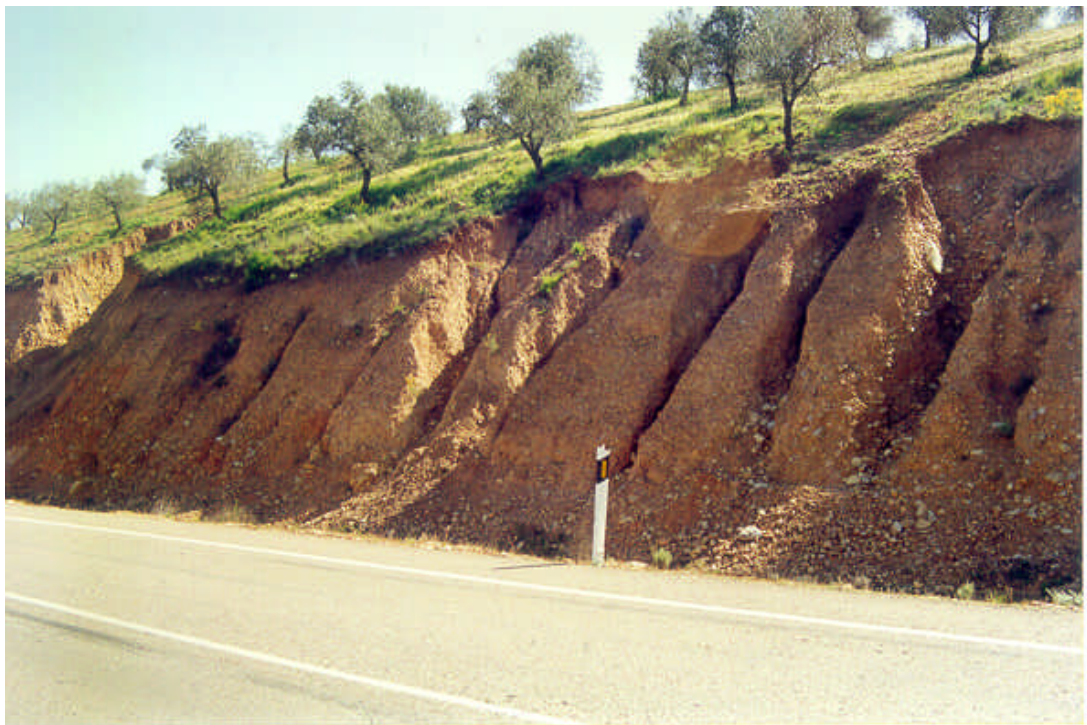
Foto nº 46. Fuertes erosiones y acarcavamientos por efecto de las aguas de escorrentía sobre un talud excavado en los conglomerados y fangos pliocenos (grupo litológico 322). P.K. 227+000 de la carretera N-430.
