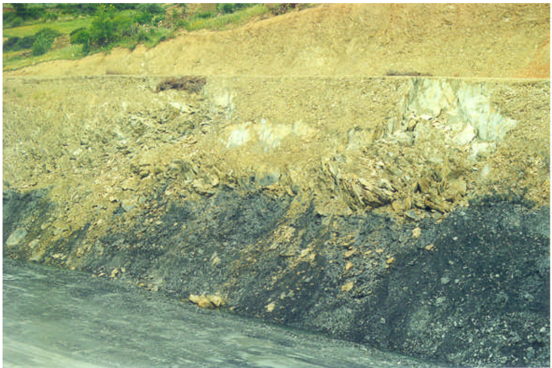
Foto nº 24. Rotura de un talud por vuelco de los planos de esquistosidad a favor del contacto con las pizarras ampelíticas. P.K. 195+000 a P.K. 197+000 de las obras de ampliación y mejora de la carretera N-430.
