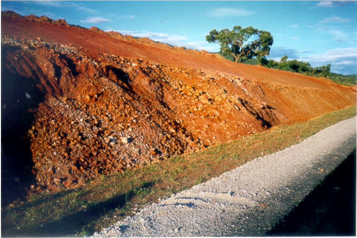
Foto nº 40. Los frecuentes deslizamientos producidos en este talud, excavado en las rañas y el manto de alteración del substrato pizarroso que integra el grupo litológico 122a, ha motivado la decisión de retaluzar a 30° este desmonte de reciente construcción. Variante de la carretera N-502.
