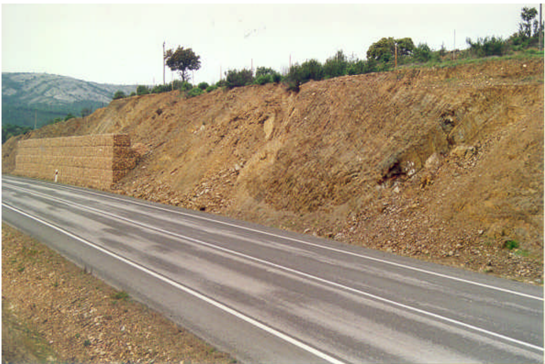
Foto nº 27. Rotura del talud por la formación de cuñas al combinarse diferentes planos de discontinuidad, favorecido por la tectonización y alto grado de las pizarras del grupo litológico 122a. P.K. 238+500 de la carretera N-430.
