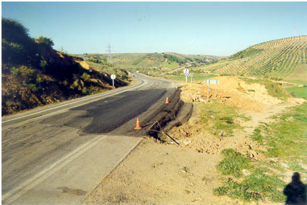
Foto nº 37. Importante asentamiento de la calzada con rotura del firme por deslizamiento del relleno que se cimenta sobre un recubrimiento coluvial en precario estado de estabilidad; y que, a su vez, descansa sobre el manto de alteración de la formación pizarrosa que conforma el grupo litológico 122a. P.K. 229+000 de la carretera nacional 430, en Puebla de Don Rodrigo.
