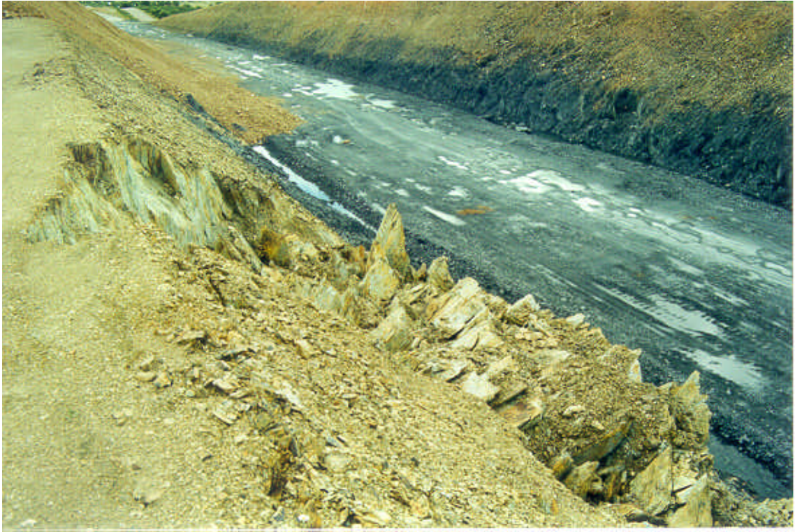
Foto nº 25. Rotura de un talud por vuelco de los planos de esquistosidad a favor del contacto con las pizarras ampelíticas. P.K. 195+000 a P.K. 197+000 de las obras de ampliación y mejora de la carretera N-430.
