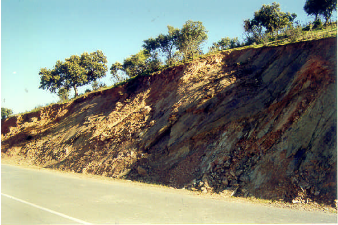
Foto nº 26. Deslizamientos planares a favor de superficies de esquistosidad y fallas en un talud excavado en las pizarras del grupo litológico 122a, en el P.K. 2+800 de la carretera de Puebla de Don Rodrigo a Arroba de los Montes.
