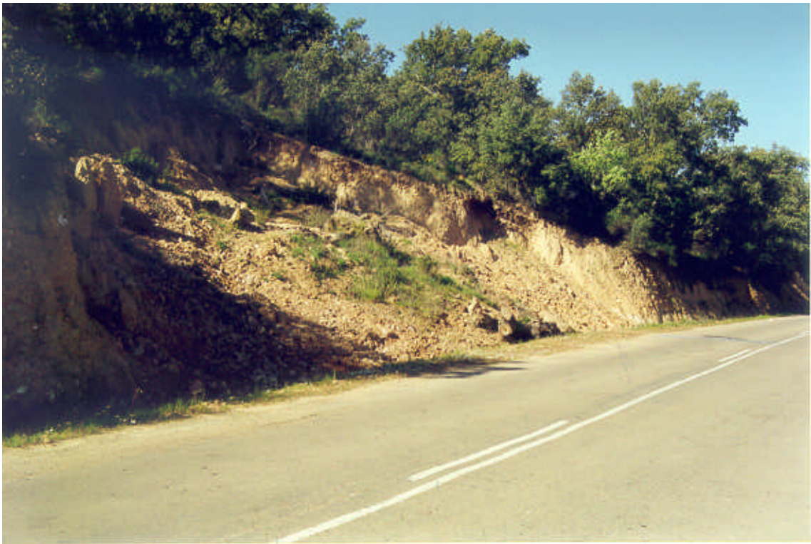
Foto nº 15. Deslizamiento en un talud excavado en materiales coluviales que descansan sobre el manto de alteración del grupo litológico 010a. P.K. 9+000 de la carretera que conduce de La Puebla de Don Rodrigo a Agudo.
