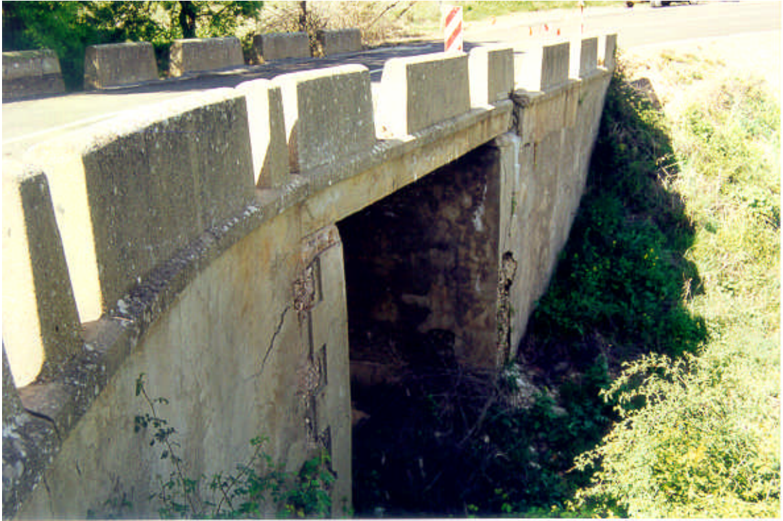
Foto nº 38. Las grietas y muros vencidos que se observan en este puente son debidos a los empujes ejercidos por un deslizamiento de ladera en el que se ven involucrados los coluviones y el manto de alteración del substrato precámbrico. En Valdemanco del Esteras, carretera con dirección a Baterno.
