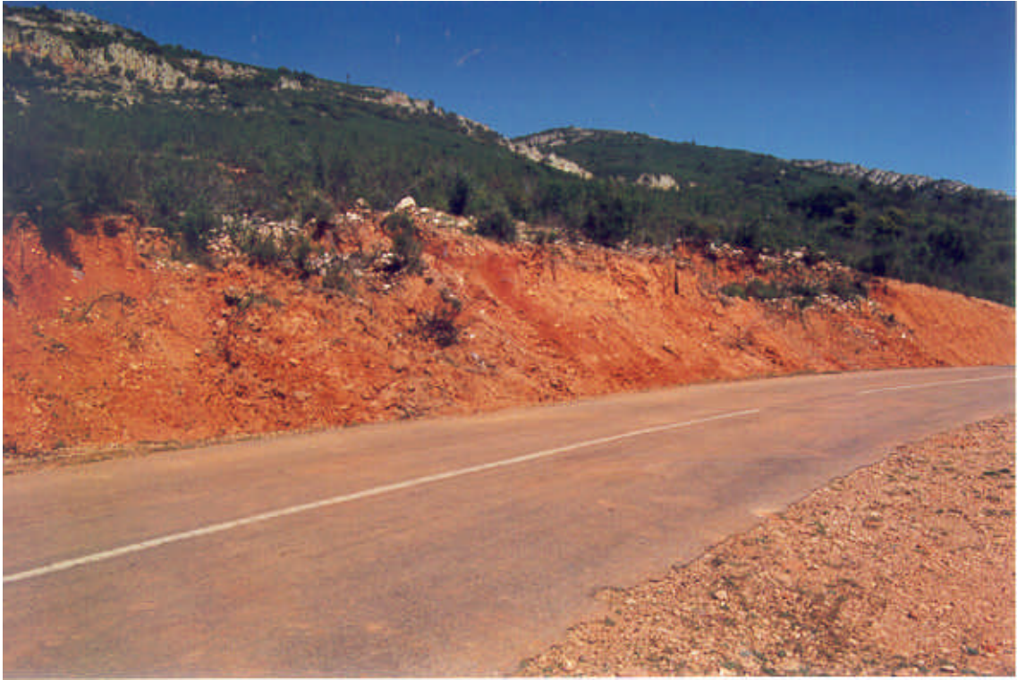
Foto nº 13. Deslizamientos en los taludes practicados en las masas coluviales que se extienden al pie de las sierras cuarcíticas, donde el agua infiltrada en las pedreras aflora por el pie de los desmontes. P.K. 4+800 de la carretera que conduce de Puebla de Don Rodrigo a Arroba de los Montes.
