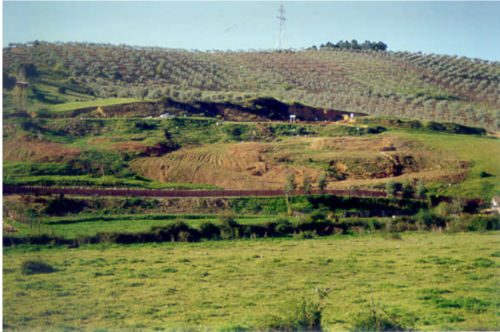
Foto nº 36. Deslizamiento del relleno de la carretera, que se cimenta sobre un recubrimiento coluvial en precario estado de estabilidad; y que se ha visto favorecido por agua que se infiltra por la cuneta y circula por el contacto entre el coluvión y el substrato. P.K. 229+000 de la carretera nacional 430, en Puebla de Don Rodrigo.
