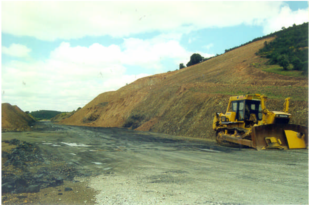
Foto nº 23. Entre el P.K. 195+000 y el P.K. 197+000, las obras de ampliación y mejora de la carretera N-430 se han visto afectadas por numerosas roturas de los taludes, que, en algún caso, han obligado a retaluzar a 30º un desmonte diseñado en principio con taludes 1H:1V. Son las pizarras del grupo litológico 122a.
