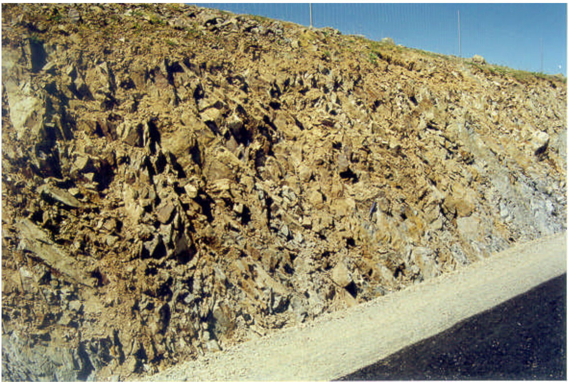
Foto nº 49. Desmante de reciente construcción en la formación de grauvacas y pelitas, intensamente tectonizadas, del grupo litológico 010a, en las proximidades de Agudo.
