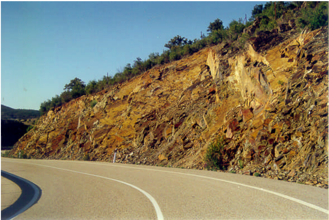
Foto nº 52. Formación de grandes cuñas por la combinación desfavorable de planos de discontinuidad en un talud practicado sobre las grauvacas y pelitas del grupo litológico 010a. P.K. 292+500 de la carretera nacional 502, entre Valdemanco del Esteras y Almadén.
