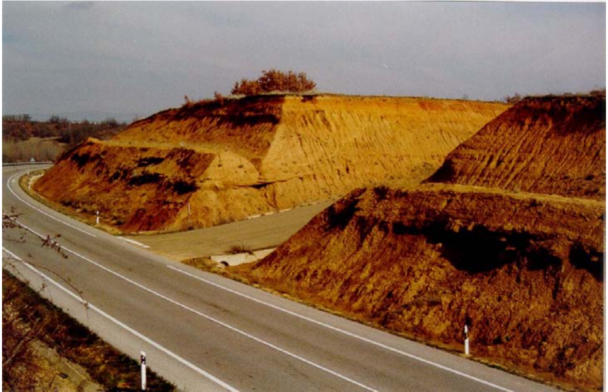
FOTO N° 15. Desmonte en los fangos de la Facies Grijalba-Villadiego (Grupo 300a) situado en el P.K. 69+800 de la carretera N-611. En los taludes se observan erosiones y deslizamientos superficiales por alteración de los fangos, debida a las aguas de escorrentía y a las que afloran por el talud a favor de los paleocanales arenosos.
