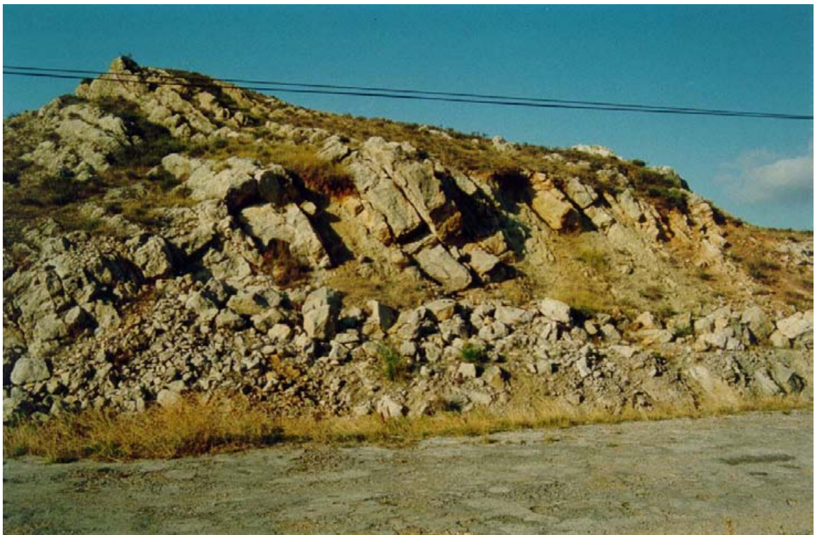
FOTO Nº 50. Desmonte situado en el P.K. 3+000 de la carretera Aguilar-Burgos, próximo a la estación de Aguilar. Afloran alternancias de calizas y lutitas del grupo 223a, perteneciente al tramo detrítico/carbonatado de la F. Purbeck.
