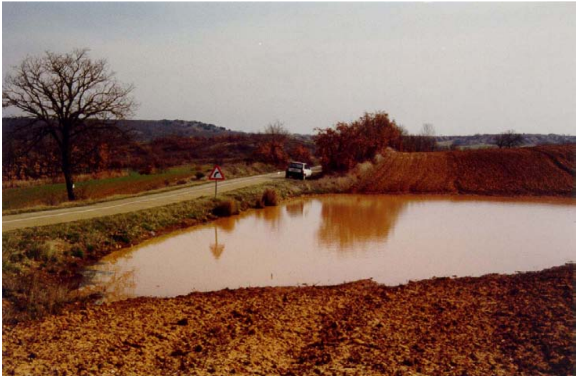
FOTO N° 16. Encharcamiento sobre los fangos del grupo 300a al quedar cegada una vaguada por el terraplén de la carretera autonómica P-232, en el P.K. 2+200, y carecer ésta de obra de drenaje transversal.
