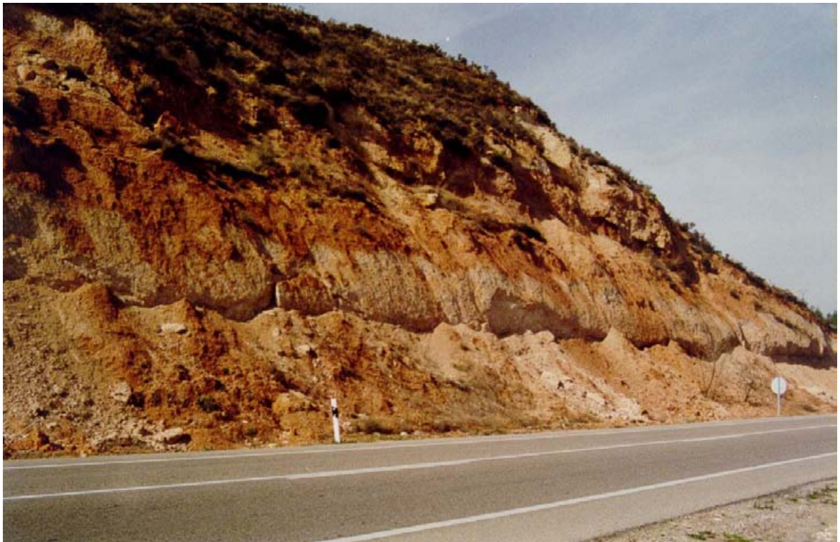
FOTO N° 21. Desmante practicado en arcillas margosas y fangos con paleosuelos carbonatados perteneciente al grupo 300b. Sobre el talud se muestran fuertes erosiones, que originan arrastres de tierras caída de bloques por erosión diferencial. Estas inestabilidades han progresado por la ladera y en la actualidad se observan grietas y asentamientos por deslizamiento en puntos muy altos de la misma.
