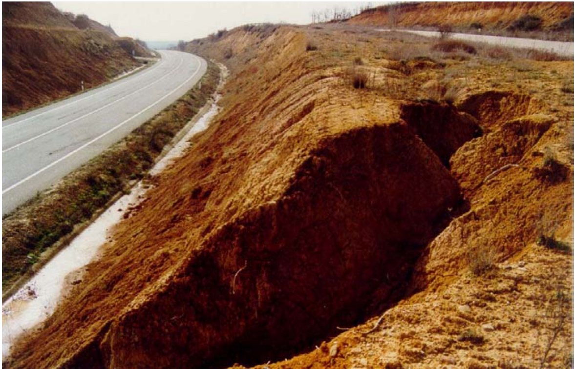
FOTO N° 17. P.K. 69+900 de la carretera N-611, donde afloran fangos y arenas del grupo 300a. Fuerte acarcavamiento del talud producido por el agua que aporta la cuneta de la antigua carretera, situada a un nivel superior, y cuyo drenaje se ha descuidado. Esta erosión origina el arrastre de tierras y el consiguiente anegamiento de cuneta actual.
