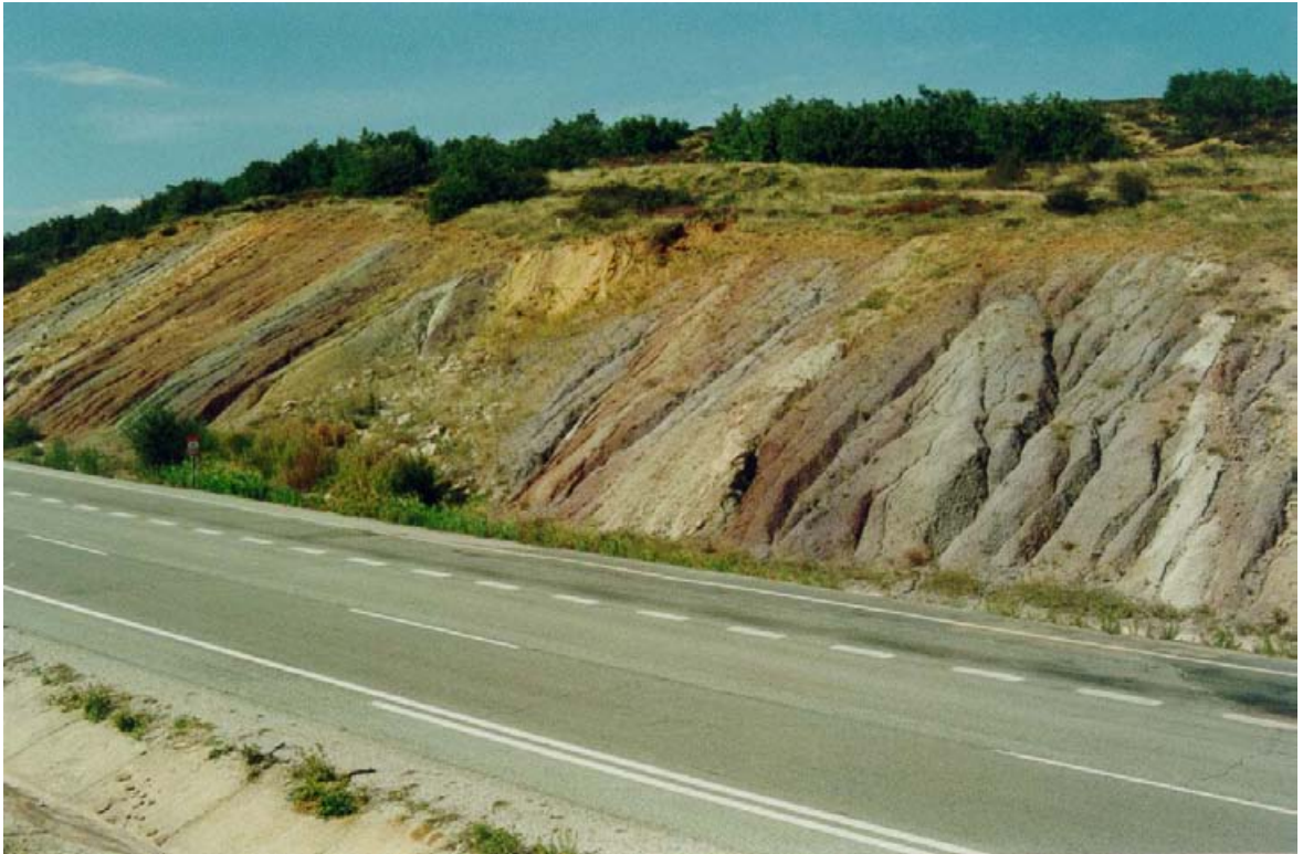
FOTO N° 44. Desmante situado en el P.K. 113+000 de la N-611. Afloran lutitas de la F. Purbeck (grupo 230a), en ciclos de oxidación/reducción, y se observan fuertes acarcavamientos y un deslizamiento de tierras, donde se ha colocado una escollera al pie.
