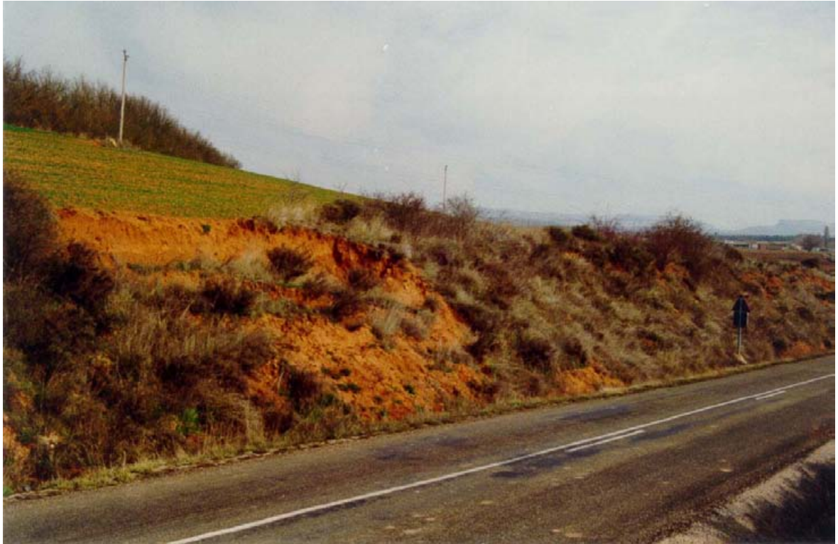
FOTO Nº 18. Deslizamiento de tierras en un talud situado en el P.K. 63+600 de la carretera comarcal C-627, entre Sotovellanos y Herrera de Pisuerga. El deslizamiento afecta a los fangos de la formación 300a, cuyas condiciones de estabilidad se han visto degradadas por la presencia de un horizonte freático en la base del desmonte, a favor de un paleocanal arenoso.
