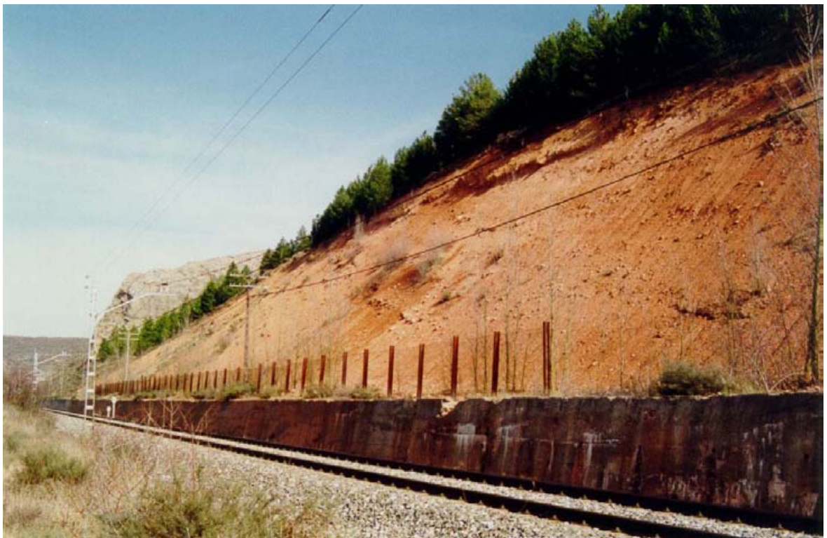
FOTO Nº 24. Desmonte del ferrocarril Palencia-Santander, en el P.K. 380+400, practicado en los conglomerados calcáreos del grupo 300c. La débil cementación que presentan estos materiales, en este punto, ha favorecido la acción de los procesos erosivos que provocan arrastres de tierras y caídas de bloques y gravas. Por ello ha sido necesario la construcción de un muro de contención de hormigón recrecido con una barrera metálica, para evitar que los arrastres inunden la plataforma.
