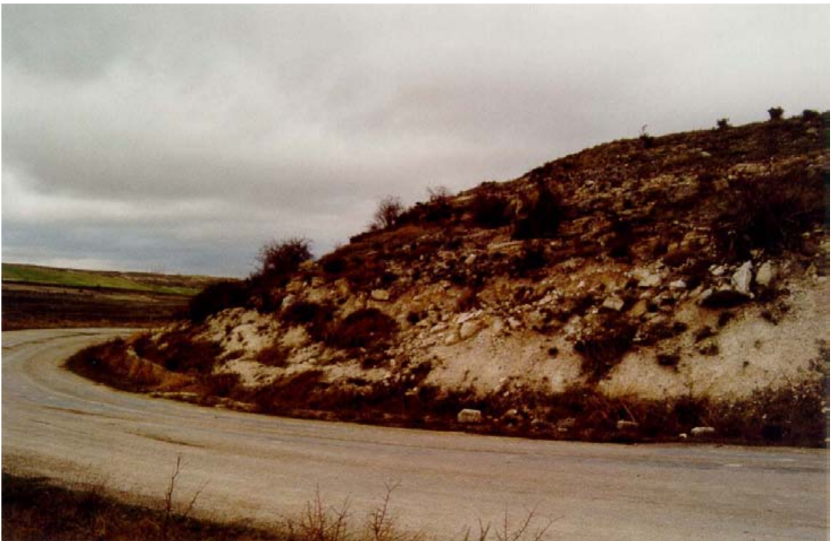
FOTO N° 5. Deslizamiento del talud de la carretera local que conduce desde Pedrosa de Río Urbel a San Pedro Samuel, muy próximo a esta última localidad, en la cuesta del páramo. El deslizamiento ha afectado a los materiales del grupo 321c, constituidos por una alternancia de calizas, margocalizas y margas. Al pie del talud se observan afloramientos de agua.
