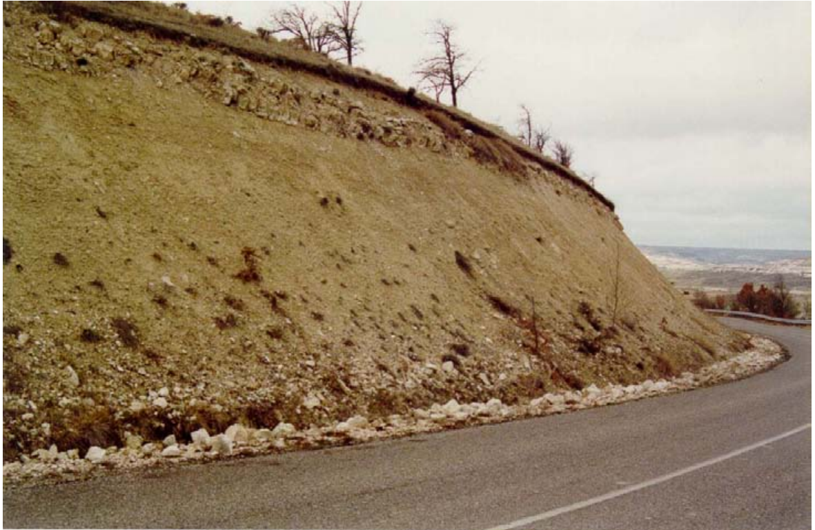
FOTO Nº 6. Margas con niveles de margocalizas aflorando en el talud de un desmonte situado en el P.K. 13+500 de la carretera local (BU-622), entre Arroyal y Mansilla de Burgos. Se originan caídas de pequeños bloques del nivel superior de margocalizas, por erosión diferencial.
