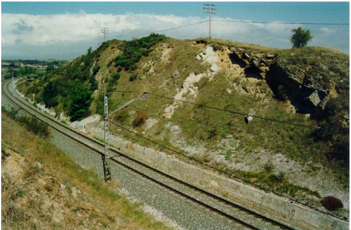
FOTO Nº 48. Trinchera del ferrocarril Palencia-Santander, P.K. 400+000. Caída de bloques por descalce y vuelco de estratos en un paquete de areniscas del grupo 231a incluido en una serie lutítica perteneciente al grupo 230c. F. Purbeck.
