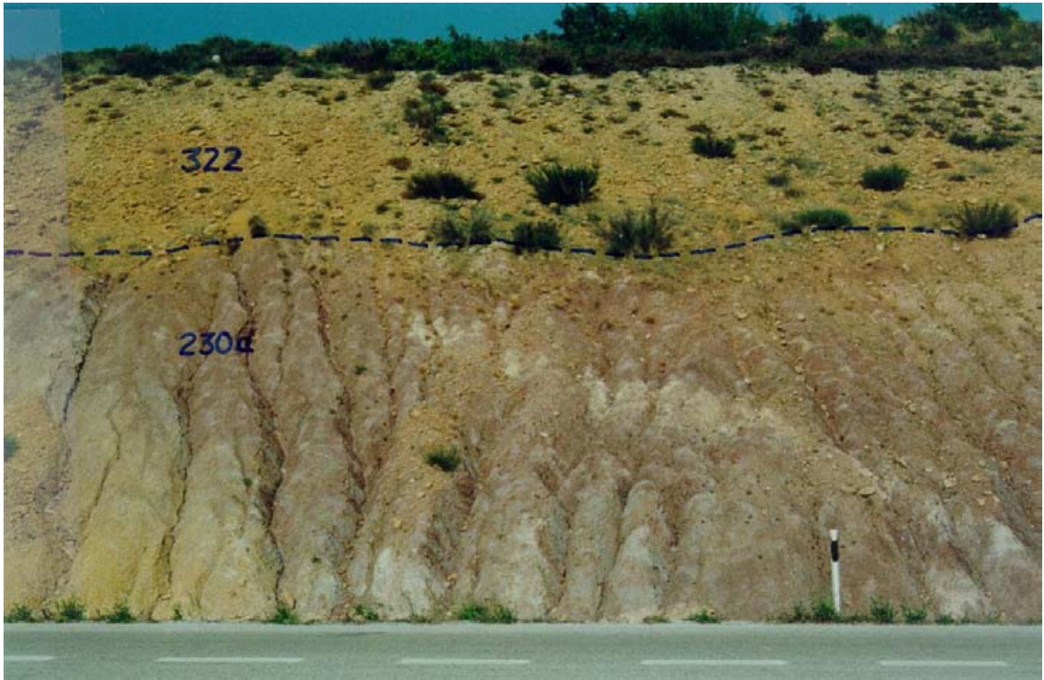
FOTO N° 33. Desmonte situado en el P.K. 112+500 de la N-611. En la parte inferior del talud afloran lutitas de la F. Weald (grupo 230a), afectadas por importantes erosiones; mientras que la coronación corresponde a un depósito de gravas del aluvial finineógeno "raña" (grupo 322).
