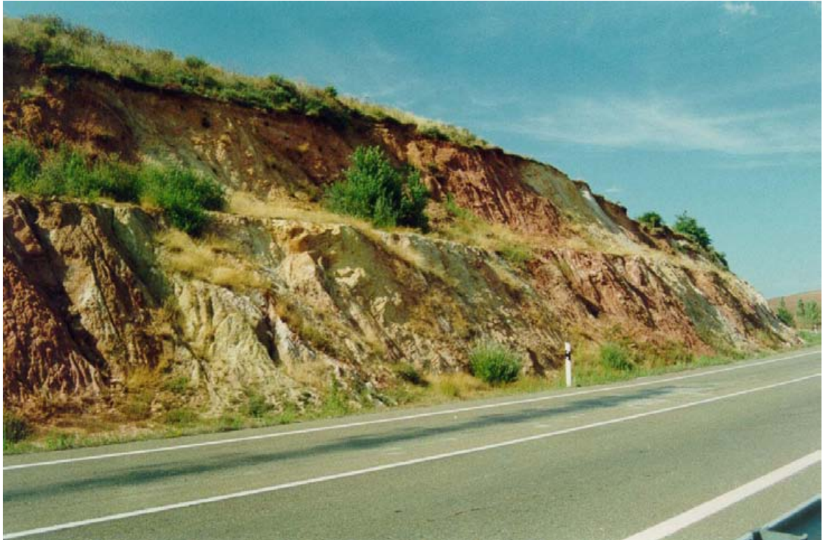
FOTO N° 43. Desmante situado en el P.K. 104+400 de la N-611, donde afloran arenas, lutitas, margas y areniscas, pertenecientes en conjunto al grupo 231a (F. Purbeck). Sobre los taludes se observan erosiones, acarcavamientos y deslizamientos superficiales de los términos más alterados.
