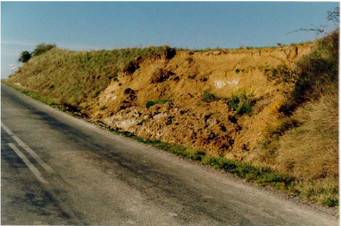
FOTO N° 10. Deslizamiento de tierras en un talud situado en el P.K. 76+400 de la carretera local entre Melgosa de Villadiego y Brullés. El recubrimiento cuaternario se ha visto inestabilizado a favor del contacto con las margas del grupo 321h, que constituyen el substrato, en un punto donde se observan afloramientos de agua.
