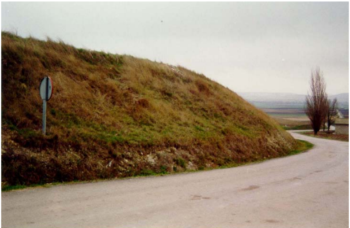
FOTO N° 9. Desmorte situado en la carretera local de Sotragero a Villanueva de río Ubierna, en las proximidades de esta última localidad. Sobre el talud se manifiestan signos de inestabilidad que afectan a margas, yesos y arcillas de la F. Villatoro (grupo 321g).
