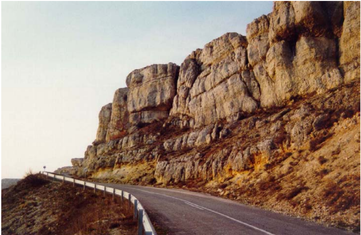
FOTO N° 39. Escarpe en el que afloran los potentes bancos calcáreos del Cretácico Superior (grupo 232c). Los planos de estratificación y fractura individualizan grandes bloques que por efecto de la erosión diferencial pueden verse inestabilizados.
