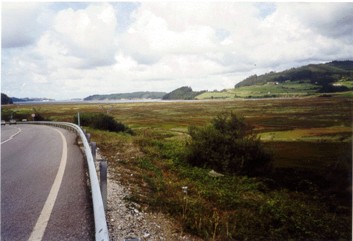
Foto 3.10. Apoyo de la Carretera N-640, entre Ribadeo-Vegadeo sobre el grupo M,m, obsérvese el deficiente drenaje superficial
