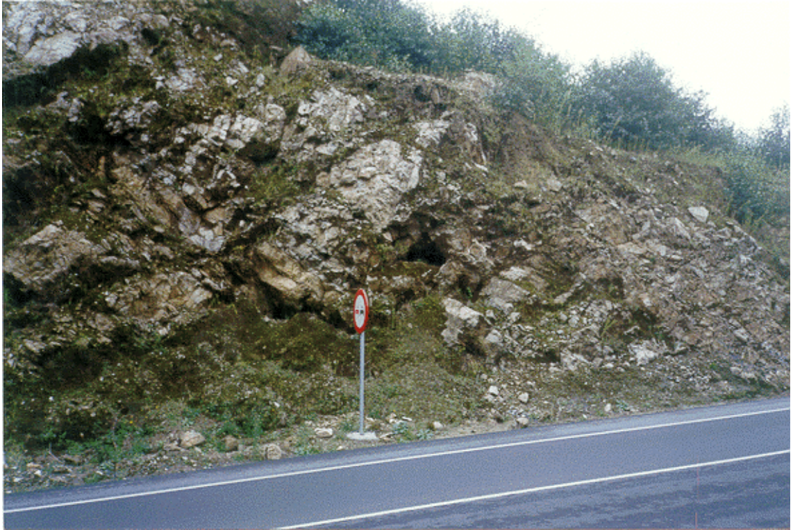
Foto 3.39. Talud practicado en el grupo litológico (111c) mostrando un alto índice de fracturación y canales kársticos
