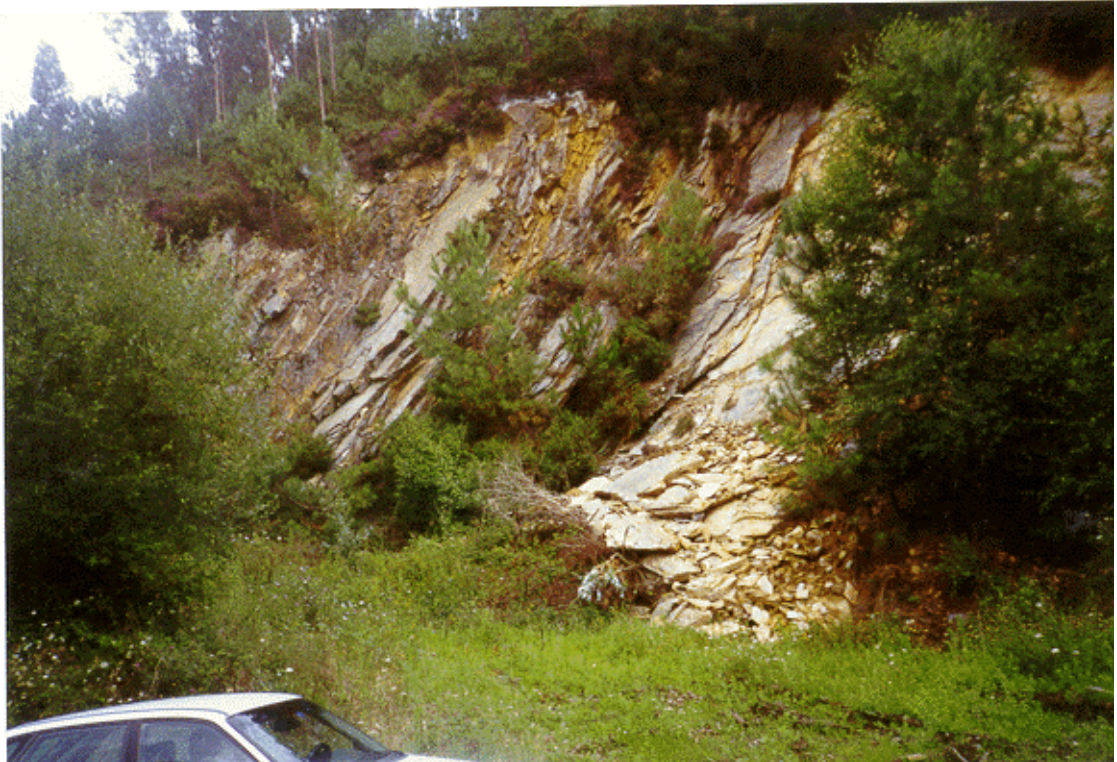
Foto 3.38. Inestabilidades en talud construido sobre el grupo litológico (121c)
