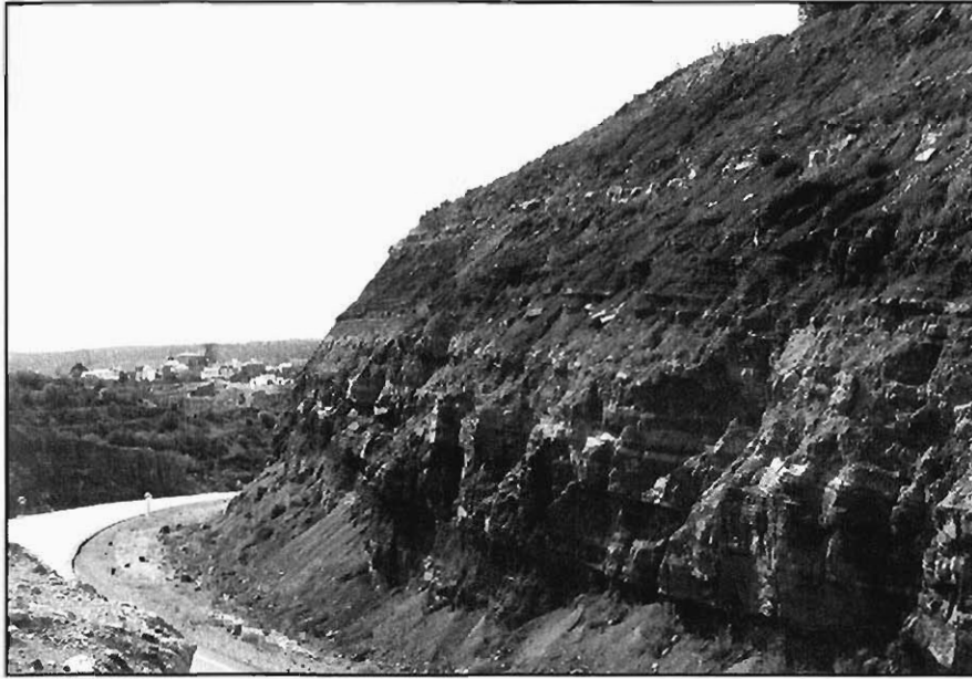
Foto 9.- Talud excavado en los materiales del grupo (231) donde se pueden diferenciar las intercalaciones areniscosas y las lutíticas. P.k. (131) de la carretera de Puebla de Valverde a Valbona. Al fondo se puede observar La Puebla de Valverde.
