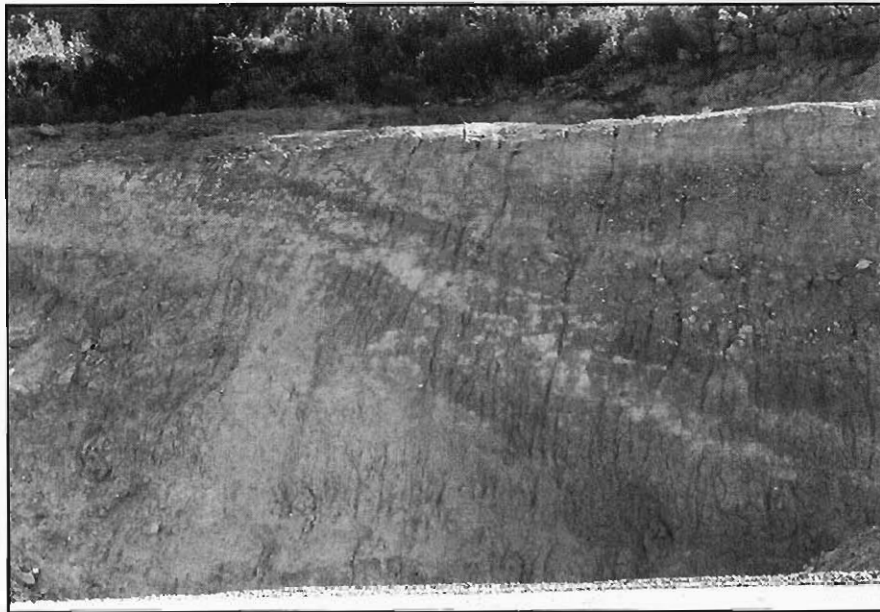
Foto 4.- Talud sobre los materiales del grupo litológico (C3). Se observan pequeños desprendimientos de materiales. El contacto con la unidad infrayacente se realiza por medio de un nivel más oscuro, que es un plano de movimiento.
