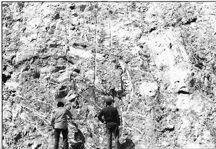
Foto 20.- Yesos masivos con venas de yesos fibroso pertenecientes al grupo litológico (213a). Son claramente visibles en el talud, las huellas de los barrenos que se han utilizado para abrir el desmonte. P.k. (27'5) de la carretera N-234.
