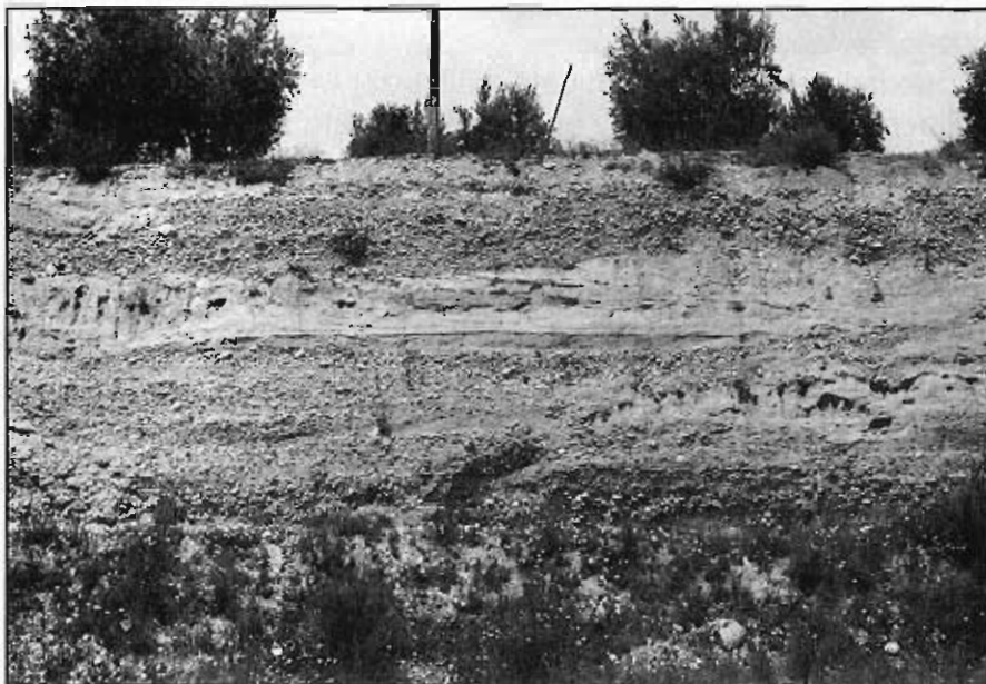
Foto 58.- Talud artificial excavado en los materiales de este grupo en el P.K. 345 de la CN-323.
