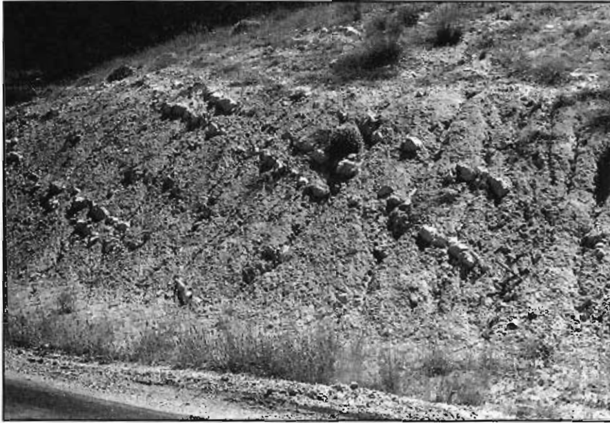
Foto 44.- Aspecto de un talud artificial excavado en los materiales del grupo 232a con predominio de términos margosos, en las inmediaciones del Cortijo de Puerto Viejo en la carretera de Los Villares a Valdepeñas de Jaén.
