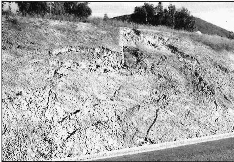
Foto 5.- Deslizamiento originado en un desmonte excavado en los materiales del grupo (321f) en la Carretera Local de Jimena a Mancha Real, a 2 km al NE de esta última población.
