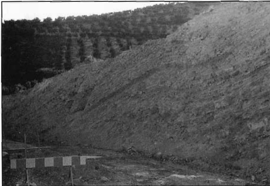
Foto 39.- Talud artificial cortado en los materiales del grupo 231c, en la carretera de Jaén a Los Villares, a 2 km al NE de esta última población.
