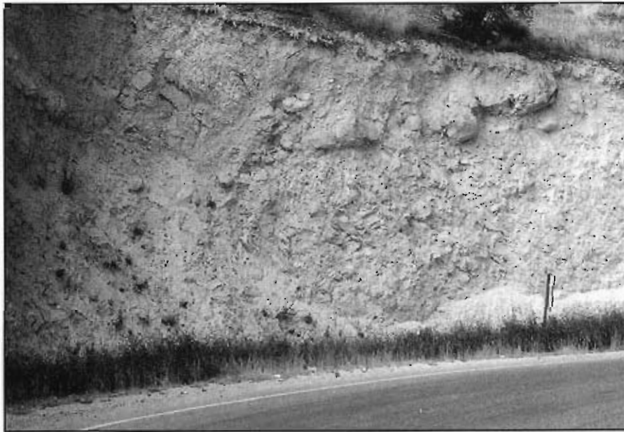
Foto 42.- Detalle de los materiales del grupo 231f en la carretera de Pegalajar al cruce con CN-323, a 500 m al SW de Pegalajar.
