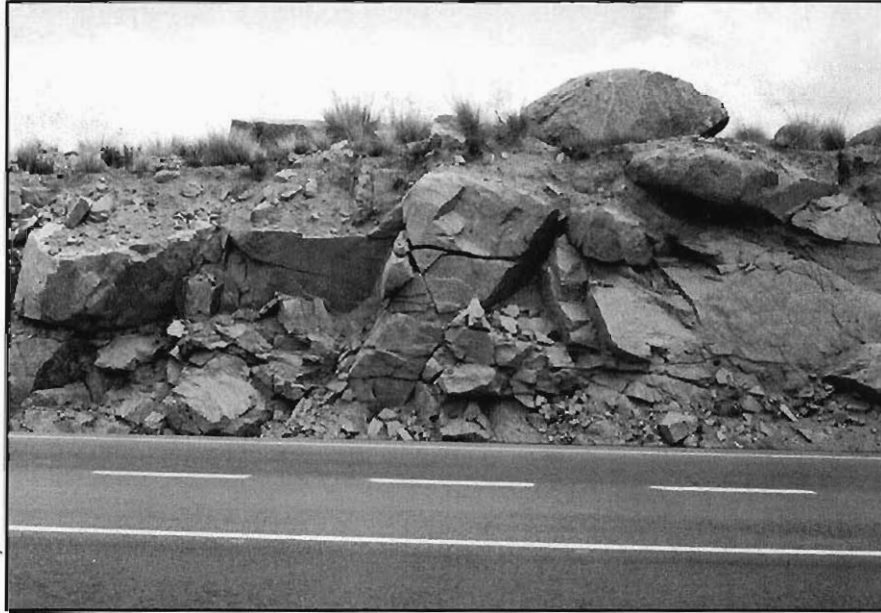
Figura 3.54.- Talud de baja altura excavado en las granodioritas del grupo 001. Puede apreciarse cómo el diaclasado origina bloques y cuñas de dimensiones variables. Kilómetro 97 de la carretera N-501 (Hoja 506-2).
