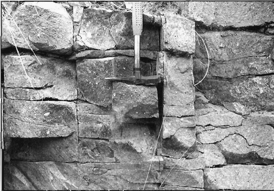
Figura 3.45.- Aspecto de los lamprófidos en uno de los filones estudiados. Obsérvese la fracturación ortogonal y la disgregación en pequeños bloques producida por la misma. Kilómetro 104 de la carretera N-110 (506-2).
