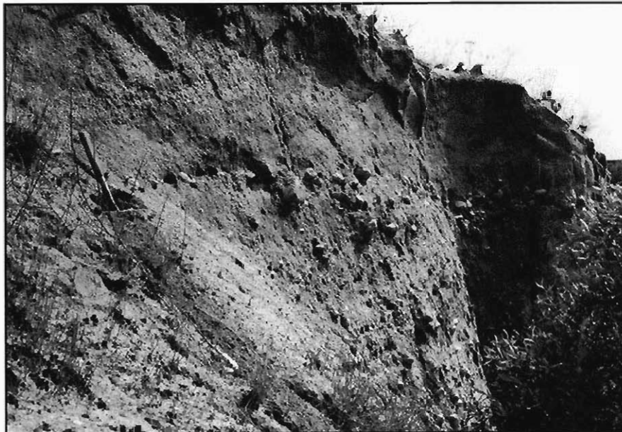
Figura 3.20.- Arenas y conglomerados del grupo (321a), en una excavación realizada en los mismos. Pueden observarse las granulometrías correspondientes a cada tipo de material. Proximidades de la localidad de Encinas de Abajo (Hoja 479-4).
