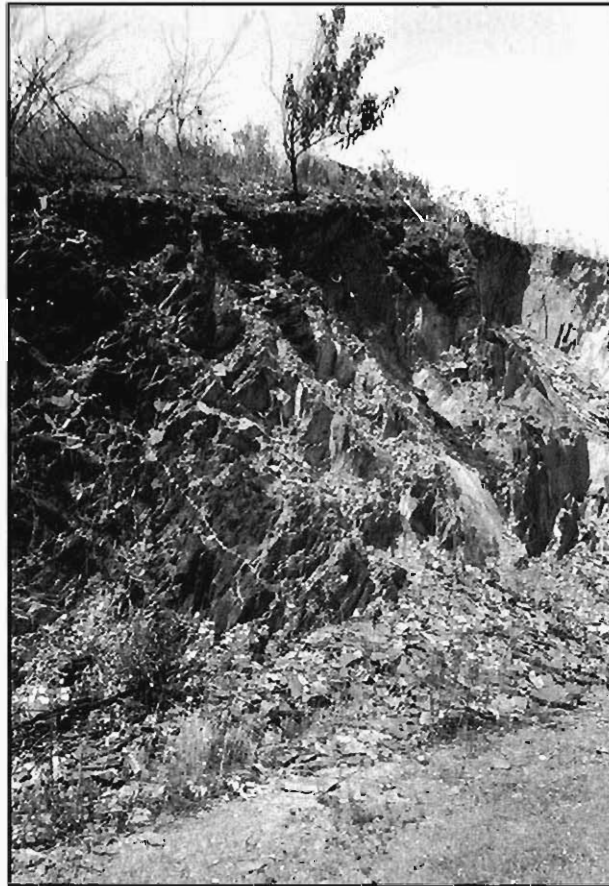
Figura 3.26.- Aspecto de las pizarras del grupo (151h) en un desmonte de la carretera abandonada de La Aulaga a Nerva (P.K. 7,800). Obsérvense los desprendimientos de lajas que se producen.
