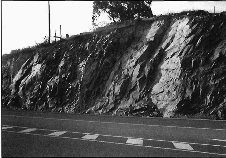
Figura 3.34.- Detalle de las caídas de lajas y bloques ocurridas en un talud de excavación en los materiales del grupo (151b). El lugar se localiza en las inmediaciones del poblado Minas del Castillo de las Guardas.
