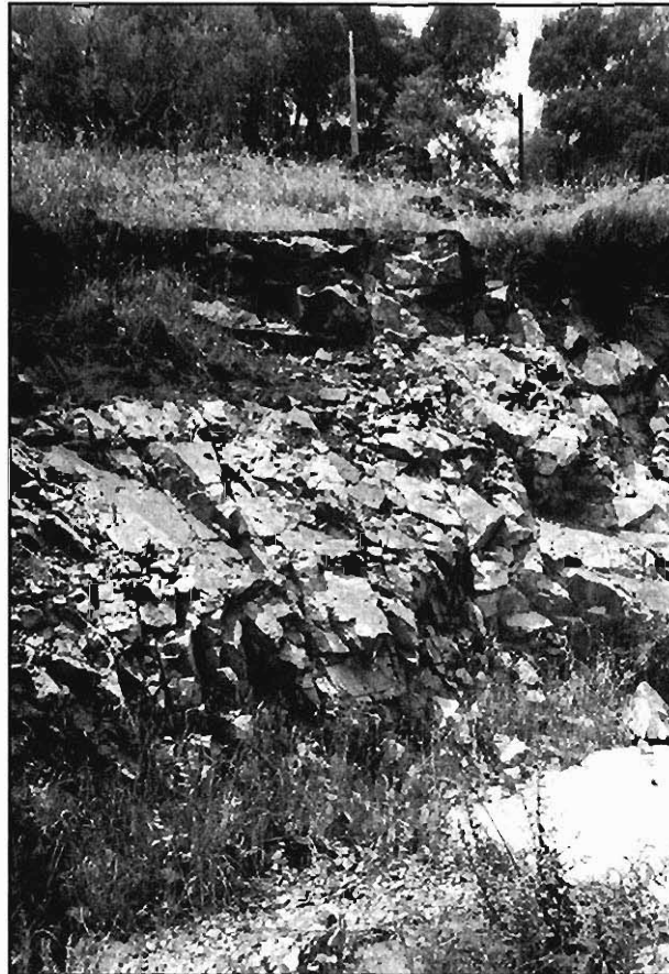
Figura 3.19.- Detalle de los mármoles del grupo (010b) en un desmonte localizado en el P.K. 45,500 de la carretera N-433, en las inmediaciones del pueblo de Valdezufre. Obsérvese la intensa fracturación que presentan.
