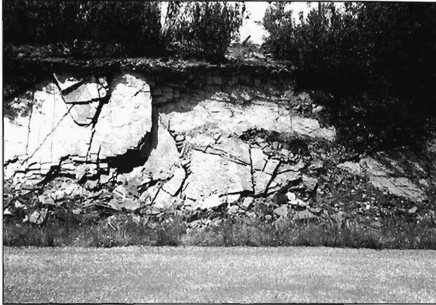
Figura 3.45.- Talud de excavación en las pizarras del grupo (143c), localizado en el P.K. 119,500 de la carretera de Castilblanco de los Arroyos a Almadén de la Plata. Obsérvese la caída de lajas que se ha producido en este talud.
