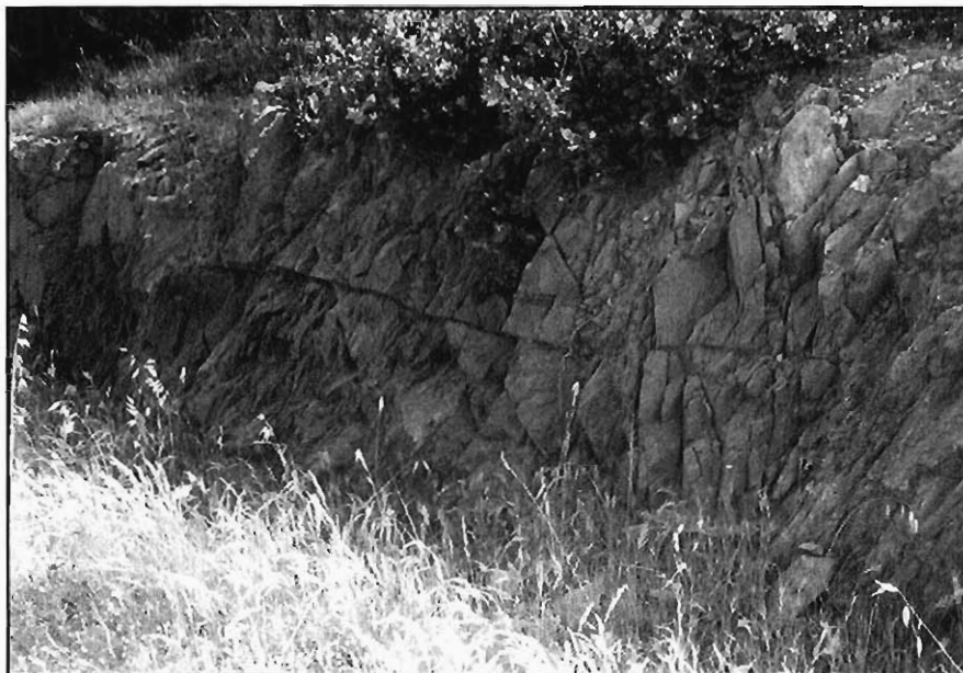
Figura 3.30.- Detalle de las lavas del grupo (151e), en un pequeño desmonte situado en el P.K. 2,500 de la carretera de Villargordo a El Alamo. Aparecen muy fracturadas y afectadas por una fuerte esquistosidad.
