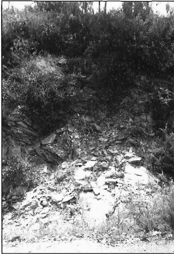
Figura 3.10.- Desprendimientos de lajas en un talud de pizarras del grupo (121c), en las inmediaciones del embalse de Aracena.
