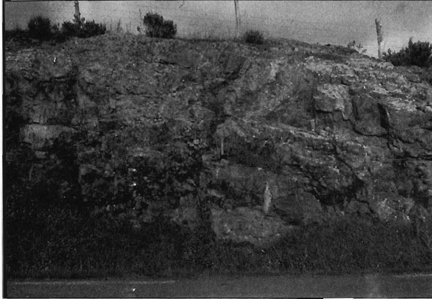
Fig. 3.29.— Desmorte en las riolitas del grupo (151d), en el P.K. 12,700 de la carretera de Villafranca de los Barros a Puebla de la Reina.
