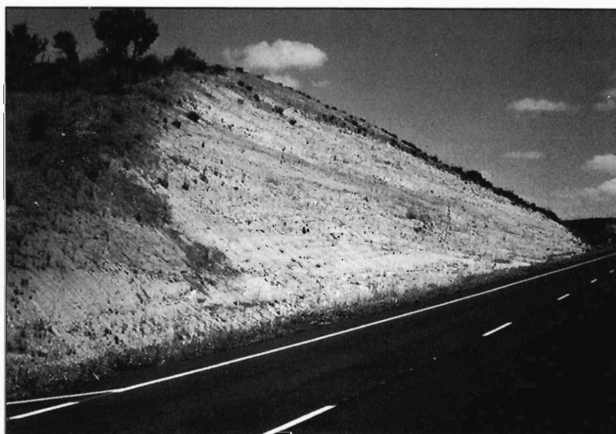
Foto 26.- Talud en el P.K. 5 de la carretera local de Morecillo a Coria (grupo 321c).
