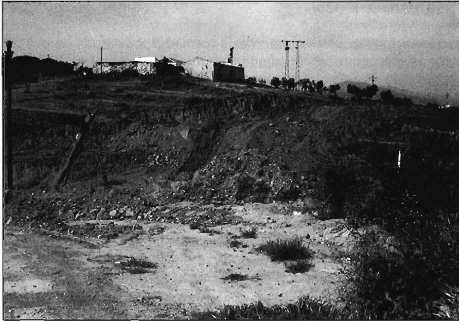
Foto 12.- Excavación de los materiales del grupo (010b) en la Variante de Plasencia, junto a la carretera de Montehermoso.
