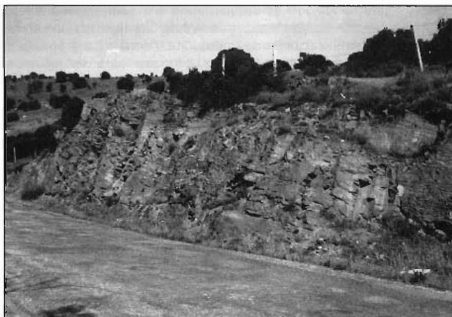
Fig. 3.53.— Pequeño talud en los esquistos del grupo (110b), en las inmediaciones de Cespedosa (528-2).
