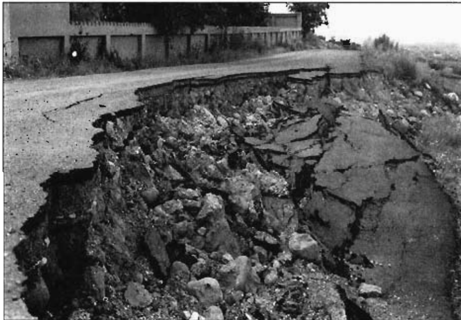
Foto42.— Grupo T2. Deslizamientos de la carretera, al efectuar una excavación vertical (derecha de la foto), sin realizar un sostenimiento adecuado.
