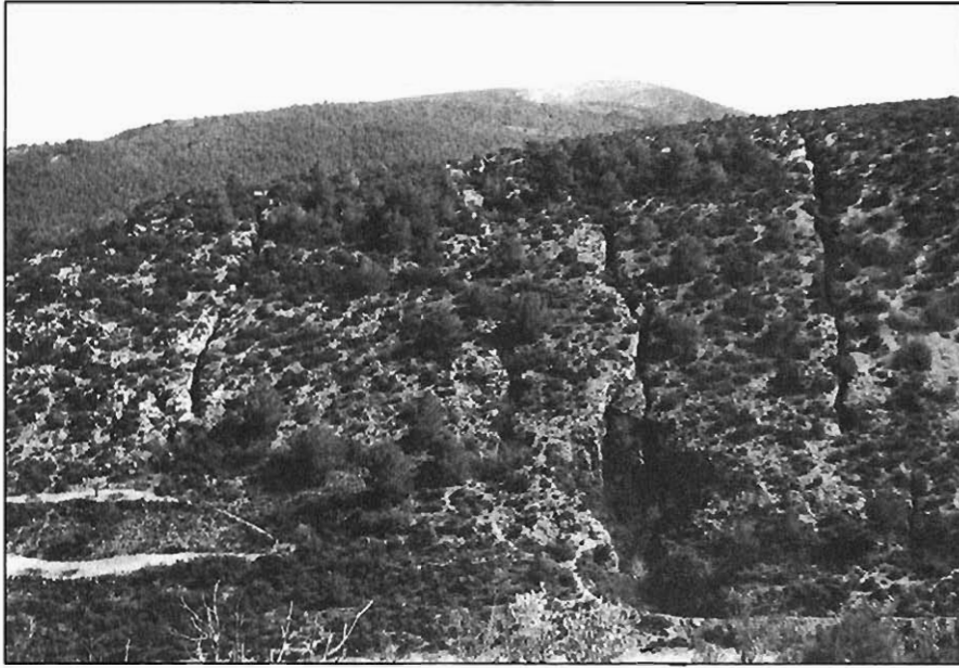
Foto 52.— Grietas en las calizas del grupo 222 por disolución de la base arcilloso-yesífera que las sustenta. (Sta. Cruz de Moya).
