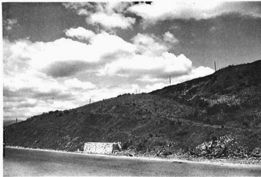
Foto 25.— Deslizamiento de las arcillas del grupo 322 en la carretera de Pizarra a Casarabonela.
