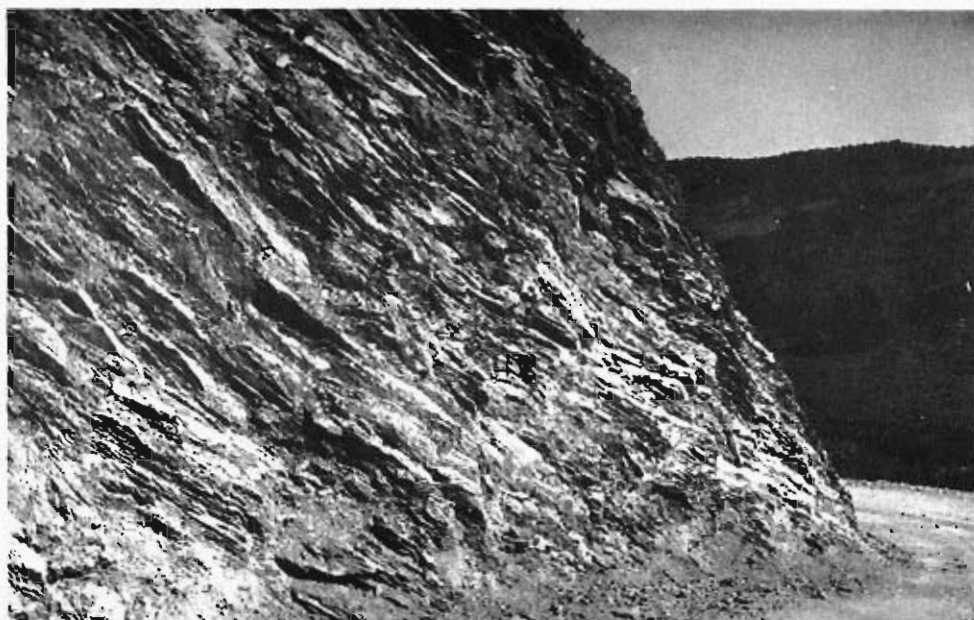
Foto 19.— Aspecto de un talud en capas rojas (232).
