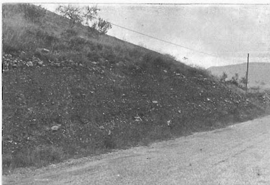
Foto 46.— Aspecto de un desmonte en los depósitos coluviales (C1). Foto tomada en la carretera Z-342, entre Illueca y Brea de Aragón.
