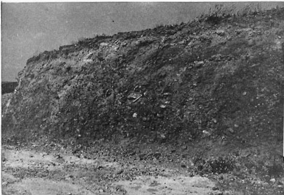
Foto 19.— Desmonte en los materiales del glacis de Borobia — Río Jalón (350a) en la carretera local de Ricla a Fuendejalón, aproximadamente P.K. 12,200.
