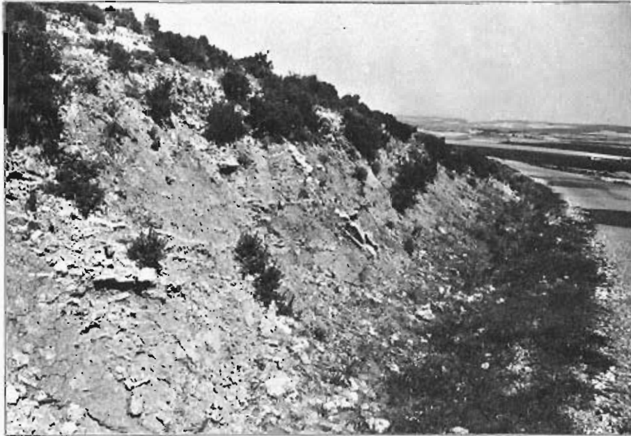
Foto 33.— Aspecto de un desmonte en las margas con yesos de Pozuelo (321h) en la carretera C-220, al sur de Pozuelo de Aragón.
