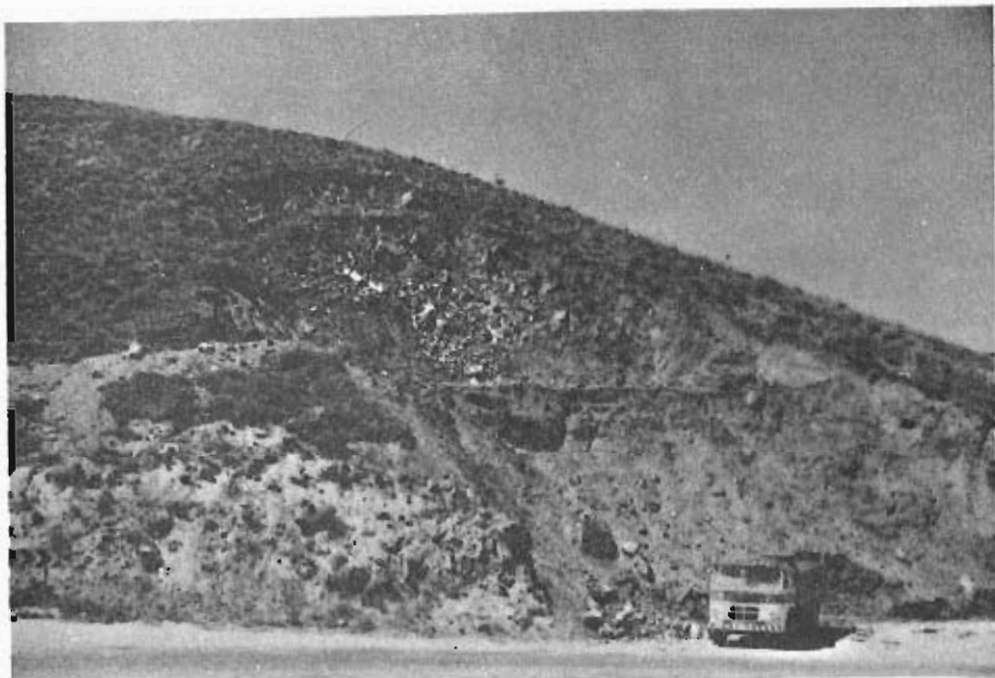
Foto 17.— Deslizamiento del grupo (221a) al realizarse un talud artificial en la CN-II
