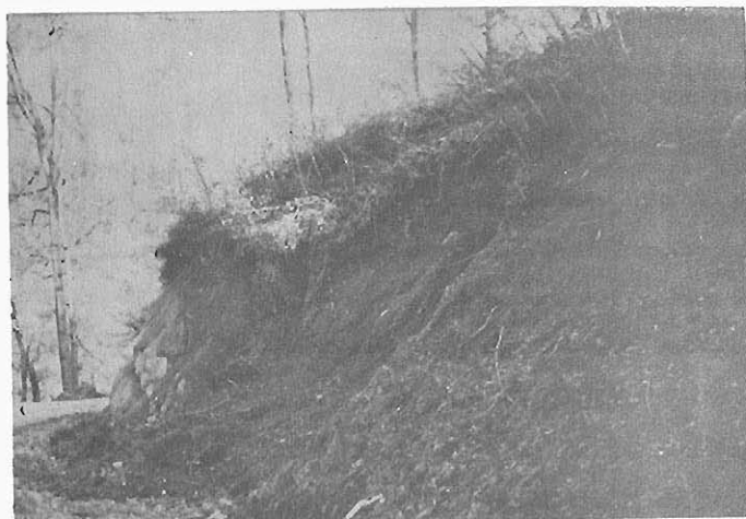
Foto 23.— Deslizamientos de los suelos eluvio—coluviales de la Cruz del Marqués. (Cuadrante 83—1).
