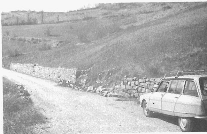
Foto 42.— Rotura del muro de contención por empuje del suelo coluvial en la Carretera local S-V-6145. (Cuadrante 108-2).
