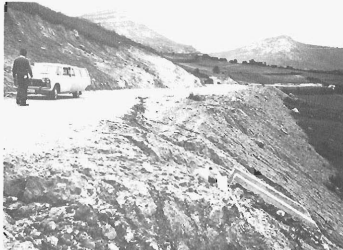
Foto 44.— Deslizamientos en los taludes de excavación y terraplenado de la carretera local BU–V–6423 (231a'). (Cuadrante 108–1).
