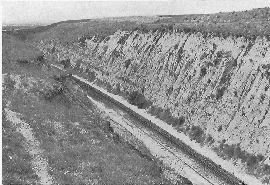
Fot. 38. Talud artificial en el grupo 350 a, con problemas de aterramientos.
