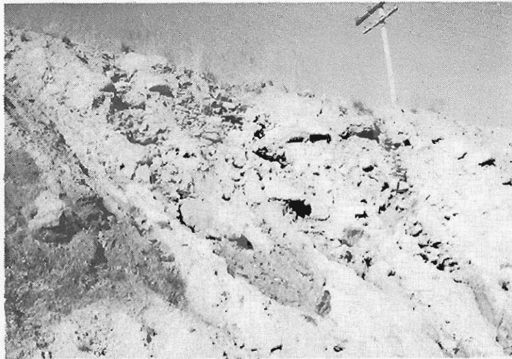
Fig. 8. Detalle de los coluviales de Somosierra que aparecen entre los kilómetros 94 y 95 de la C. N.-1
