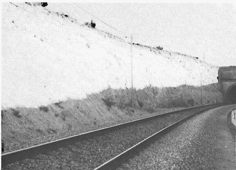
Fig. 46. Calizas pontienses, sobre arcillas margosas. Corresponde al mismo lugar de la fig. 45, en la boca sur del túnel
