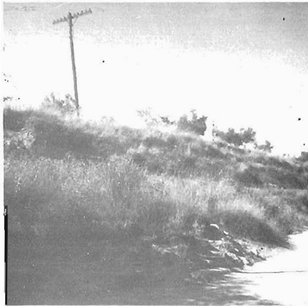
Foto 11.— Aterramiento de calzada por deslizamiento del coluvial arcillo-limoso, al SW de Jadraque. (Hoja 486-2). (97P-3).
