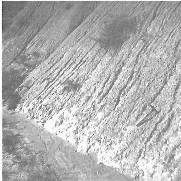
Foto 33.— Cárcavas y deslizamientos que aterran la cuneta de la C.L. Brihuega—Miralrío, P.K. 15,400. (Hoja 511-1). (97P-10).
