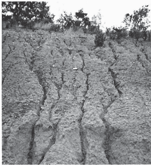
Fig. 7. Efectos erosivos en taludes de materiales detríticos (35 b) en Torrecilla del Monte
