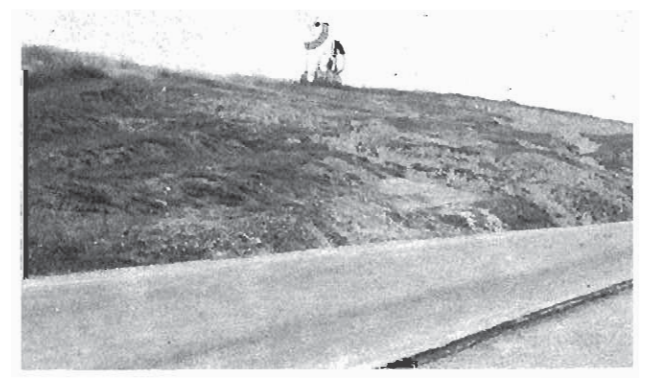
Deslizamientos en el recubrimiento arcilloso eluvial de las margas. (8b). En la N-IV 924-4 -E-4
