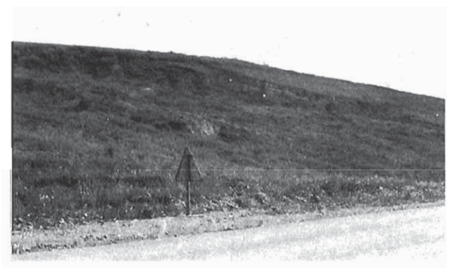
Deslizamientos en el recubrimiento arcilloso eluvial de las margas. (8b). En la N-IV 924-4 -E-4
