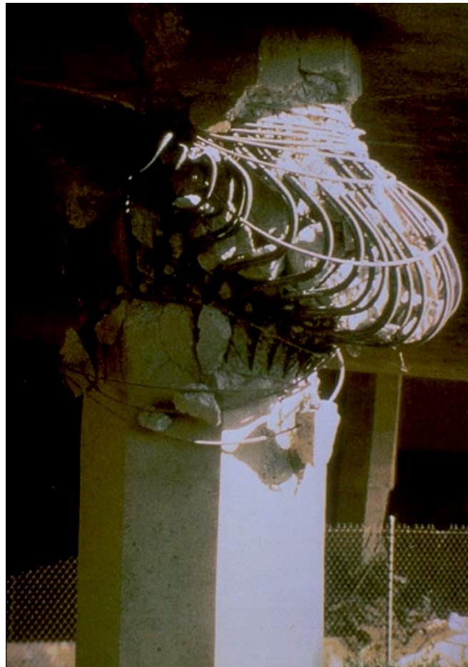
Figura 4 Colapso de una pila por proyecto inadecuado de la rótula plástica (autopista de Santa Mónica, terremoto de Northridge -17 de enero de 1994-. Fotografía de M. Celebi, US Geological Survey)
