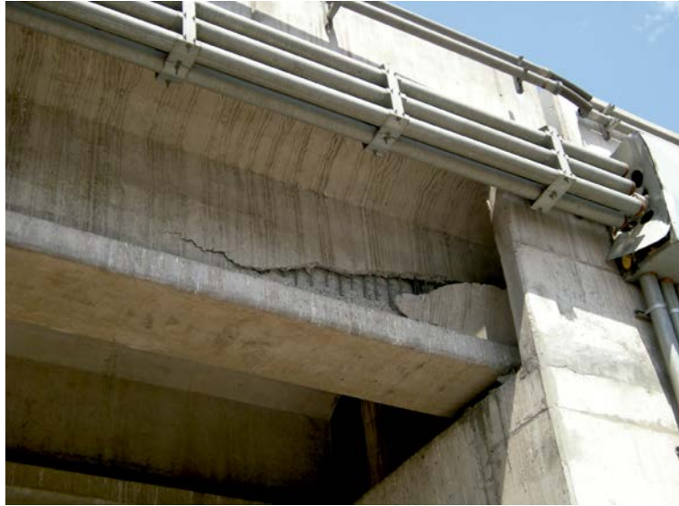
Figura 3 Fallo del alma de una viga por ausencia de diafragmas (terremoto de Concepción -27 de febrero de 2010-)
