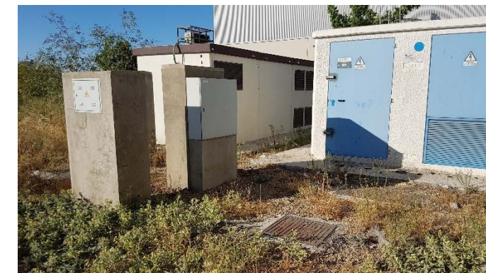
Centro de transformación de ENDESA, junto a caseta de la DGT
