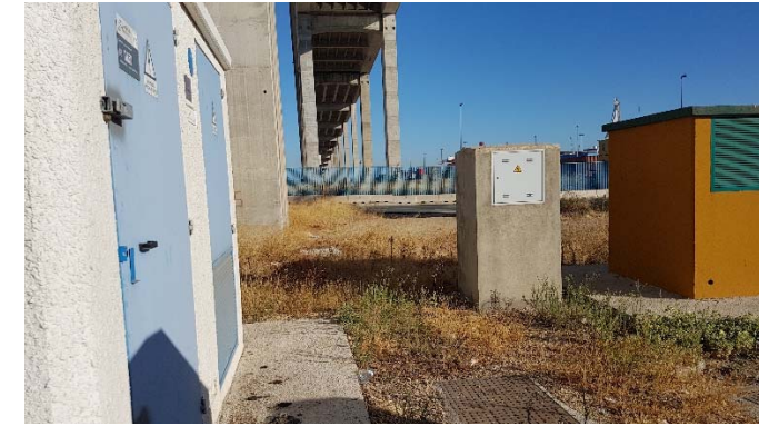
Armario y centro de transformación
