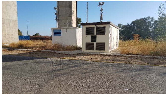
Caseta de control alimentación de la DGT
