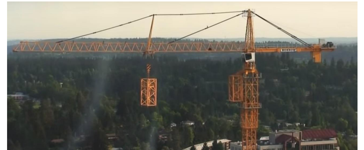
Figura 50. Grúa torre durante su proceso de auto-montaje. Izado y colocación de nuevos módulos del fuste.
