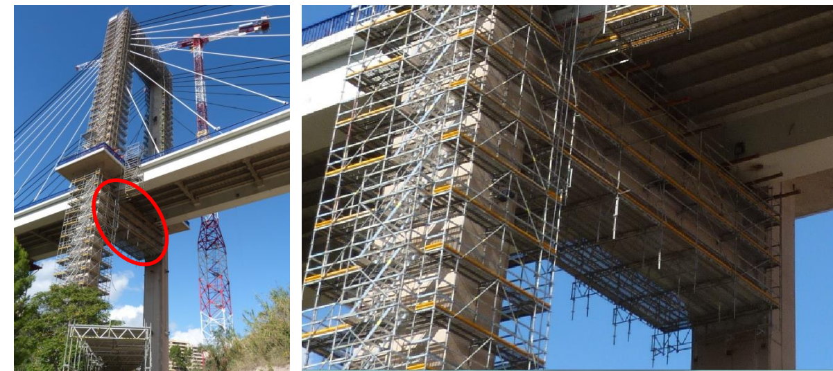
Figura 40. Andamio tipo colgado del travesaño. Izquierda: vista general. Derecha: detalle
