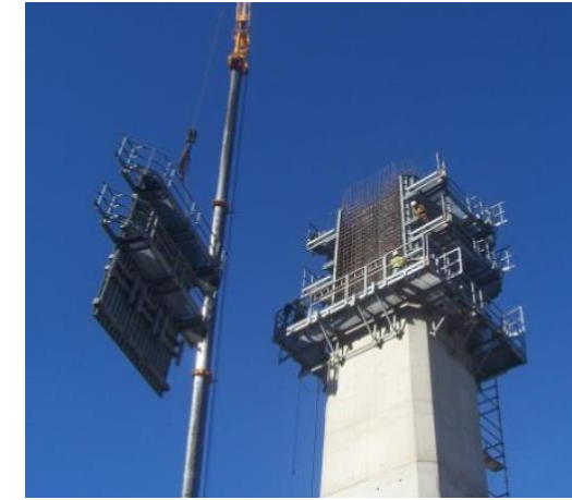
Figura 57.b. Detalle de encofrado exterior, incorporando en su diseño unas plataformas de trabajo de encofrado interior.
