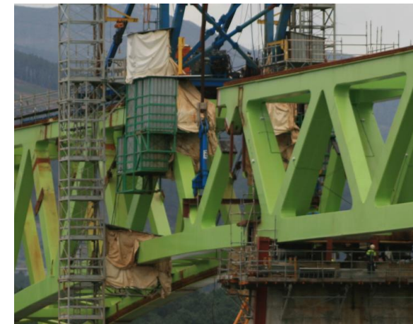
Figura 64. Carros de soldadura empleados en la construcción del Viaducto del Ulla para Adif Alta Velocidad.
