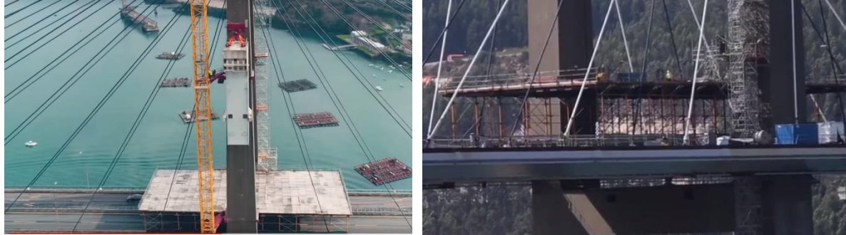
Figura 44. Pórtico de protección del tráfico rodado. Ampliación puente de Rande.
