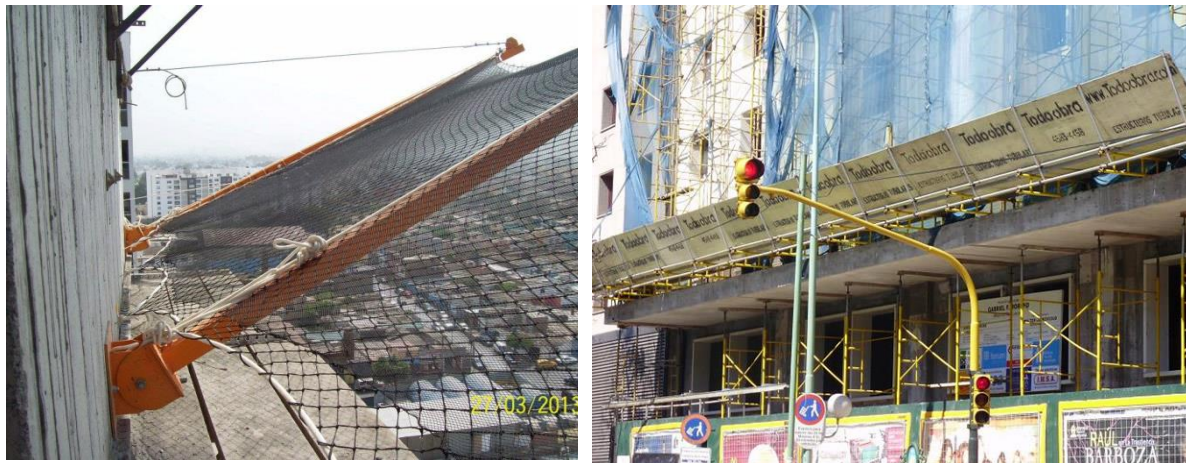
Figura 45. Red de protección y retención en obra de edificación.
