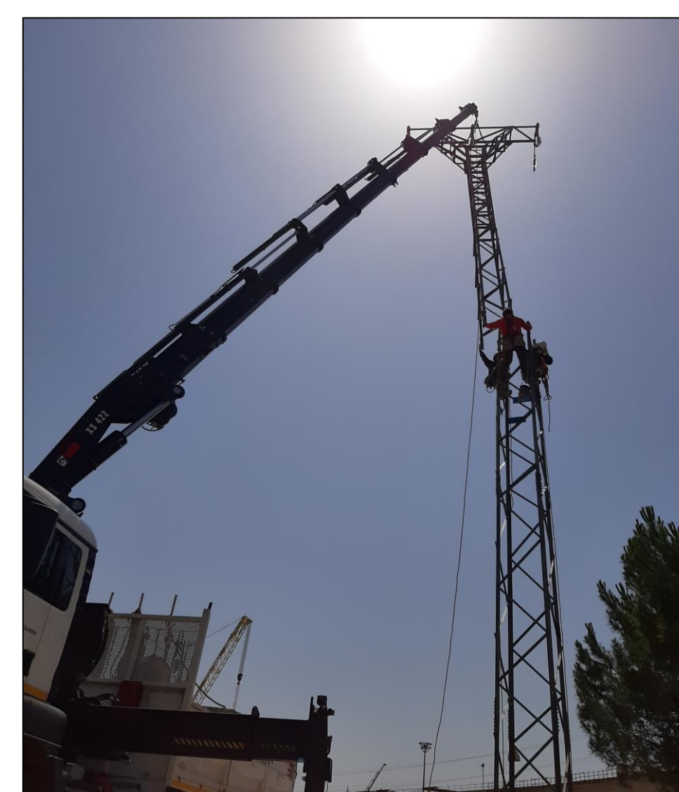
LÍNEA DE MEDIA TENSIÓN
