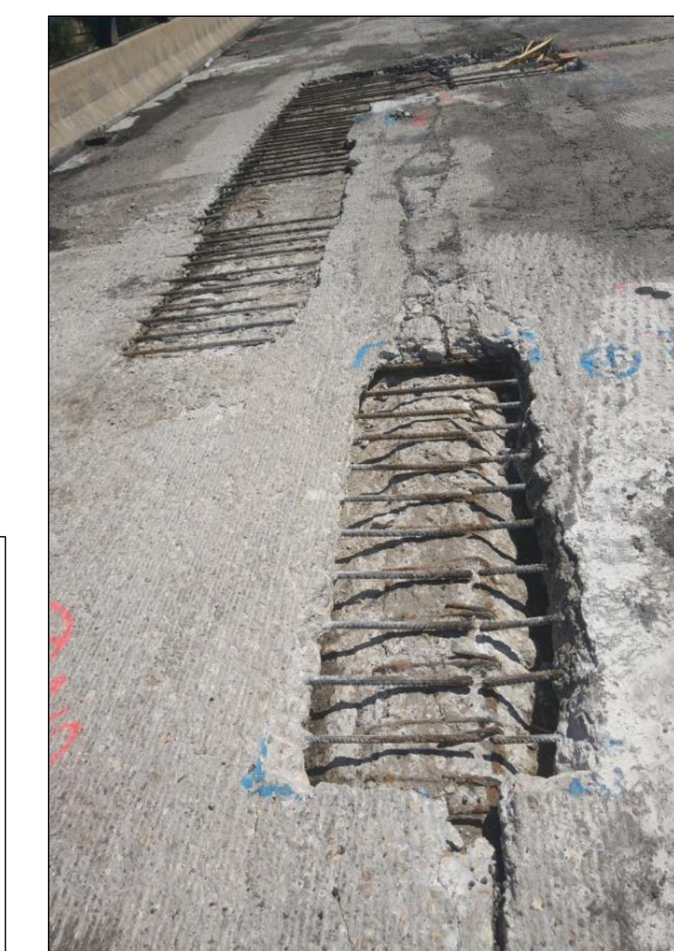
ROTURA DE BARRAS COINCIDENTE CON GRIETAS LONGITUDINALES
