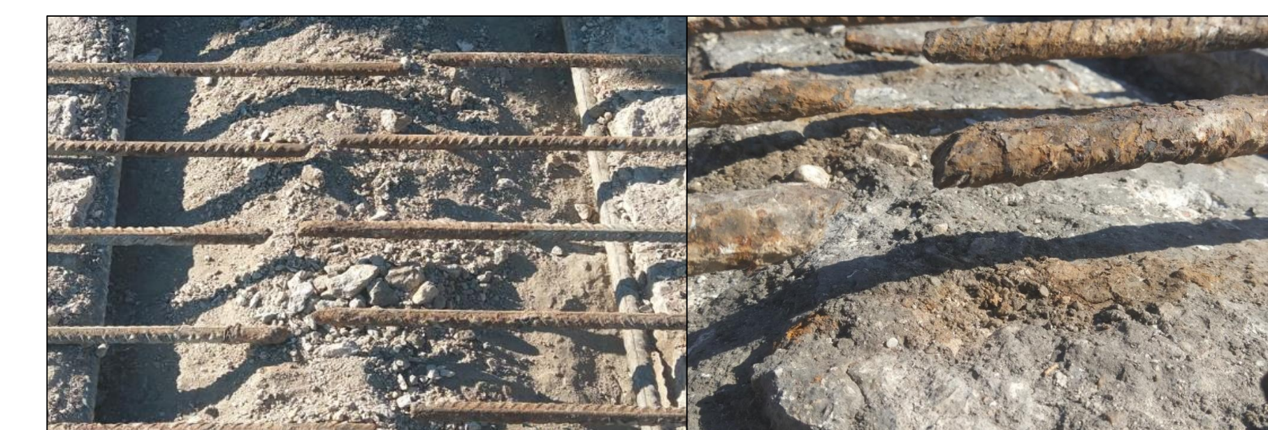
CORROSIÓN Y ROTURA DE ARMADURAS. DISCONTINUIDADES EN LA SECCIÓN
