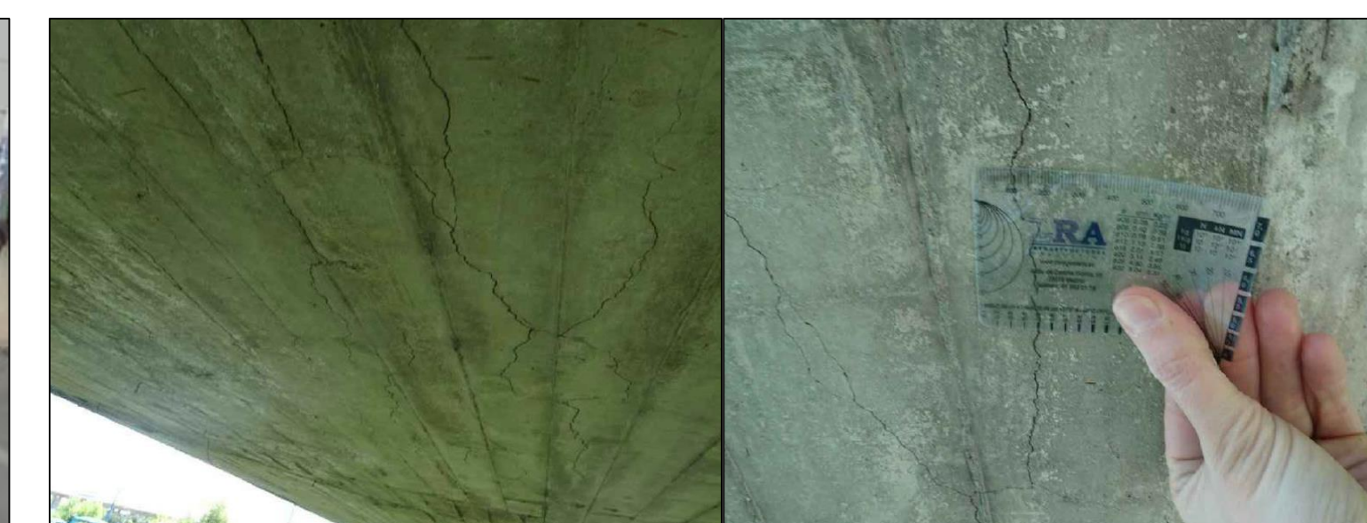
FISURACIÓN LONGITUDINAL EN LA CARA INFERIOR DEL TABLERO
