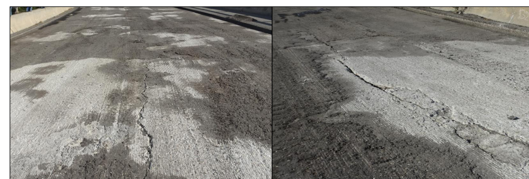
GRIETAS EN LA CARA SUPERIOR DEL TABLERO
