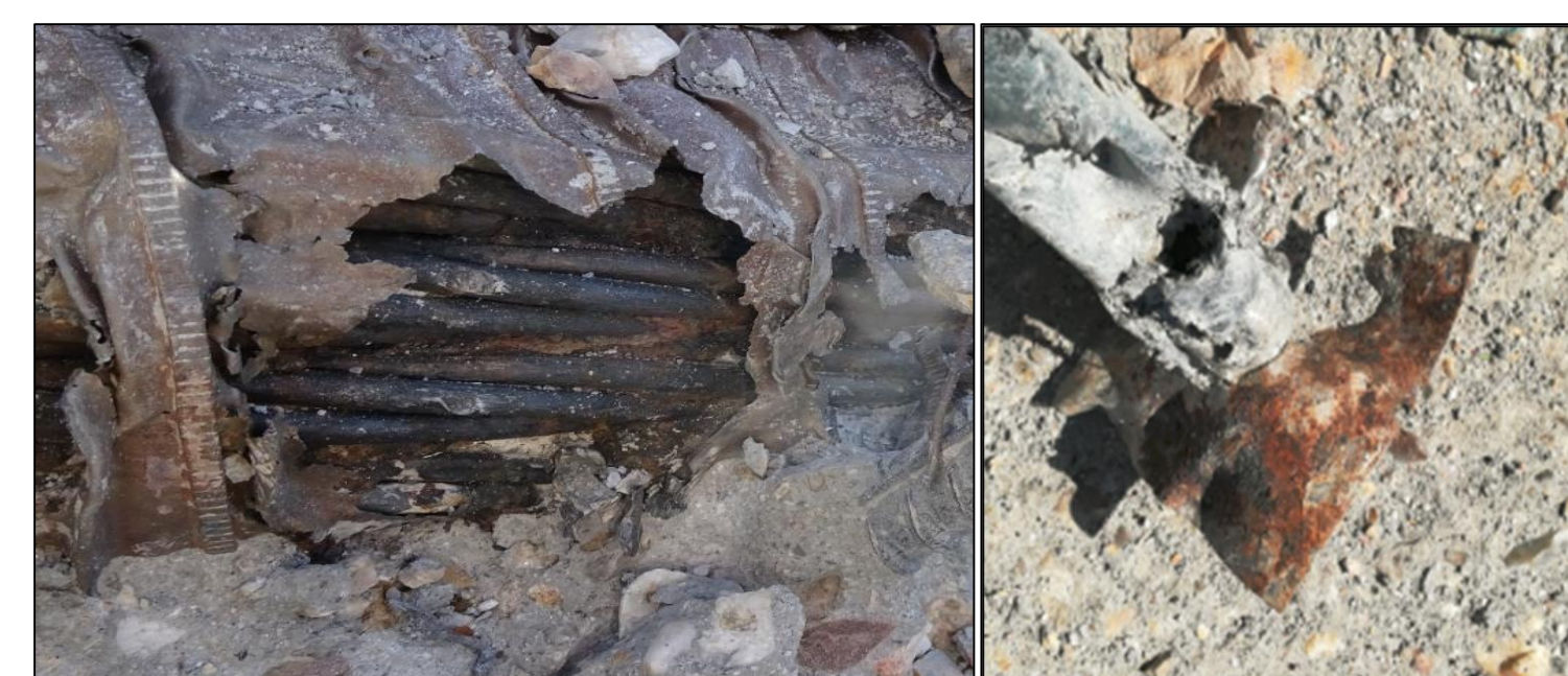
CORROSIÓN EN VAINA Y PLACA DE ANCLAJE
