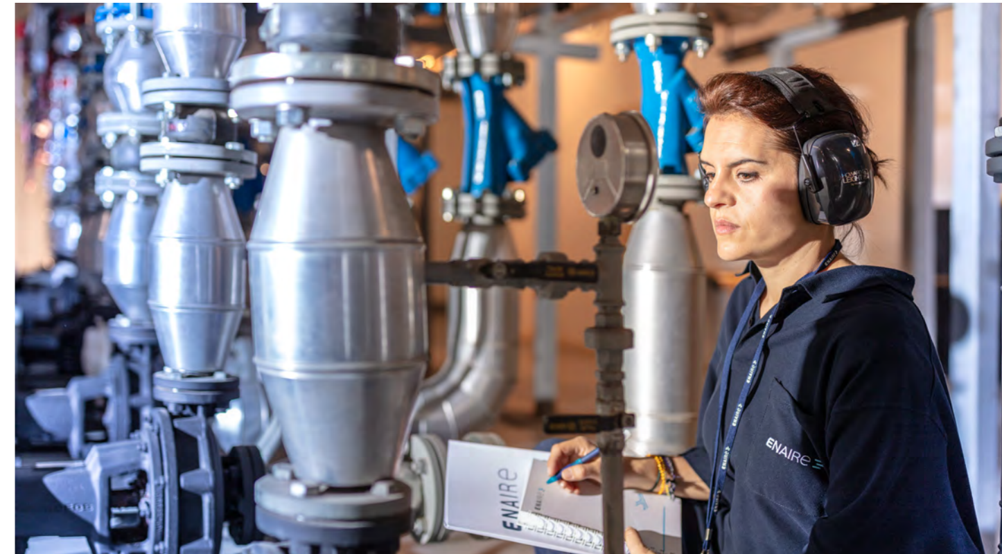
Personal de mantenimiento en Centro de Control de Área Terminal de ENAIRES en València.
