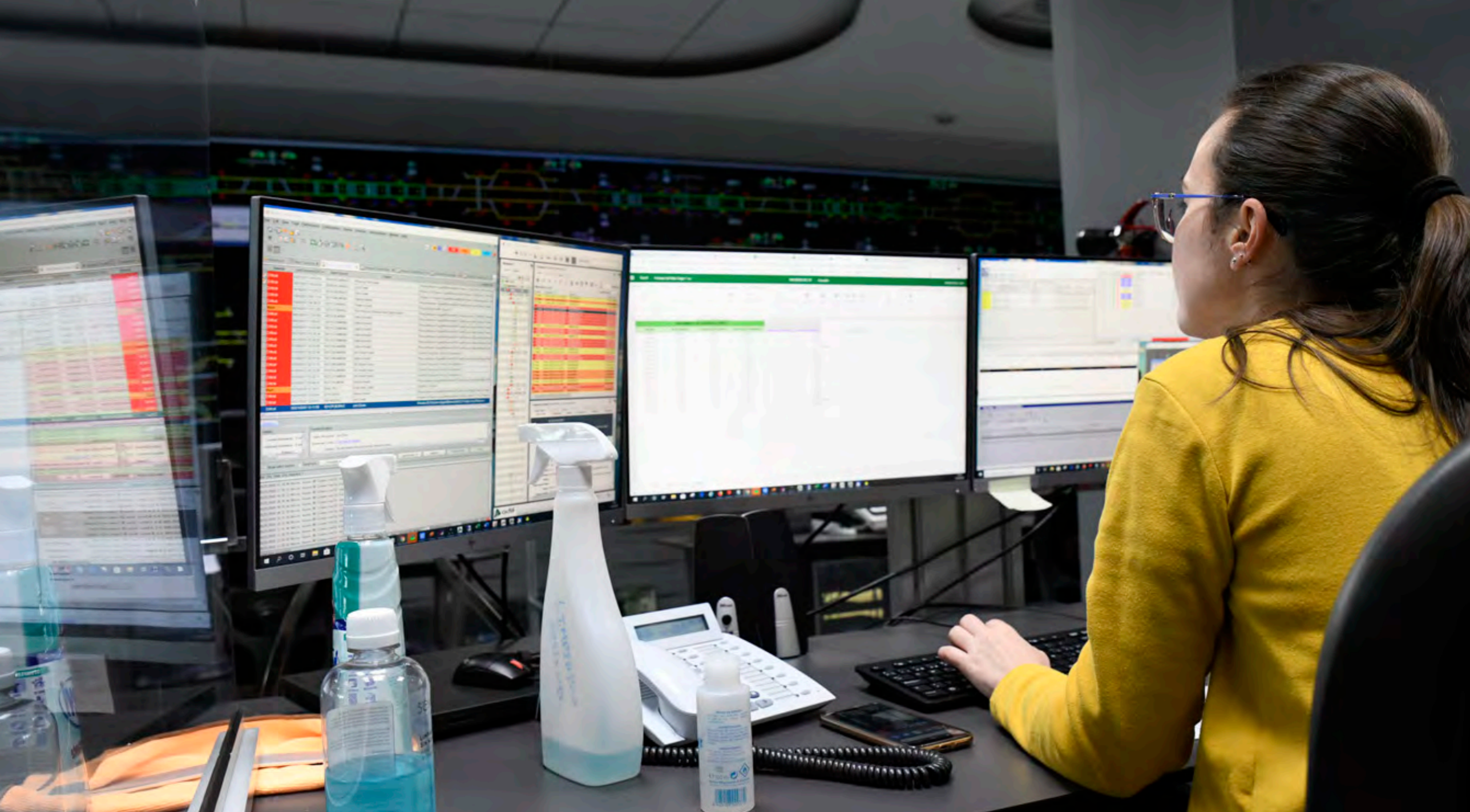
Trabajadora del CRC (Centro de Regulación de Circulación) de Atocha.
